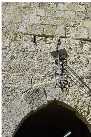
Εικ. 3.13 : Ρηγματώση υπέρθυρου ανατολικού τοίχου ισογείου (ξυουργείο)
