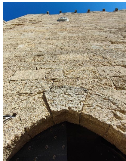
Εικ. 3.15 : Ρηγματώση υπέρθυρου δυτικού τοίχου ισογείου (ξυουργείο)
