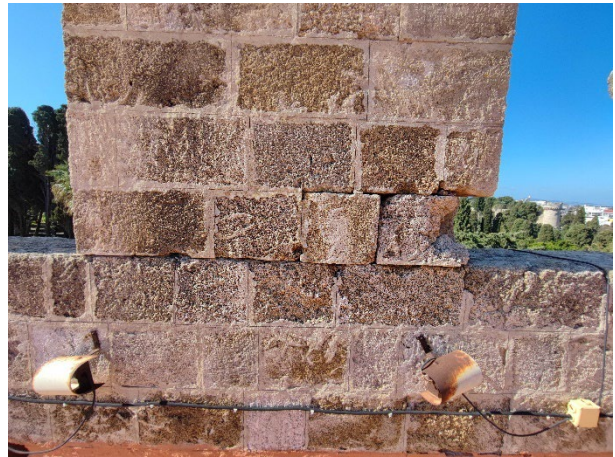
Εικ. 3.19 : Ρηγμάτωση βάσεως έπαλης ξυλουργείου
