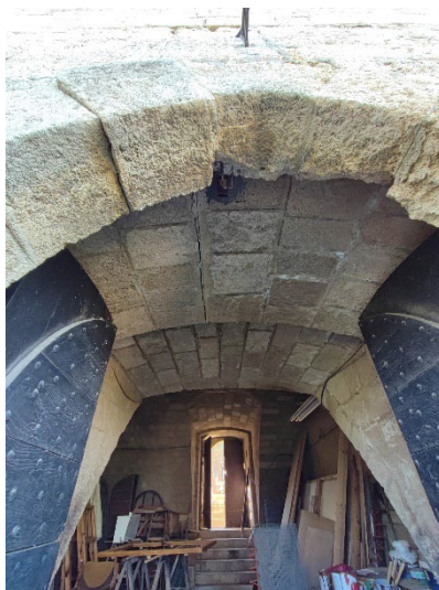
Εικ. 3.14 : Ρηγματώση θολοδομίας ισογείου (ξυουργείο)
