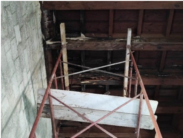
Εικ. 3.18 : Διάβρωση ξύλινων δοκών δώματος ξυλουργείου
