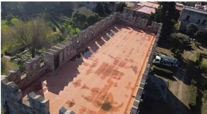
Εικόνα 67. Κτήριο Α, Γενική άποψη δώματος, λιμνάζοντα ύδατα λόγω λανθασμένων ρύσεων, παλαιότερη επισκευή μόνωσης με ασφαλτόπανα
