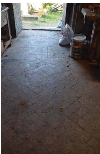
Εικόνα 58. Κτήριο Α, Θύρα Θ.101, - ρηγμάτωση βόρειου τομέα, πορεία στο δάπεδο
