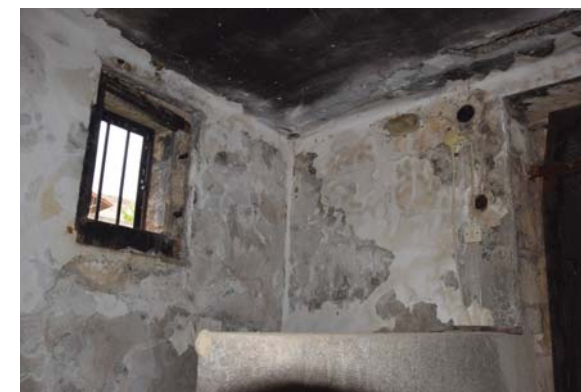
Εικόνα 76. Κτήριο Β, διάβρωση τοιχοποιίας και πλάκας οροφής κλιμακοστασίου Β.102α
