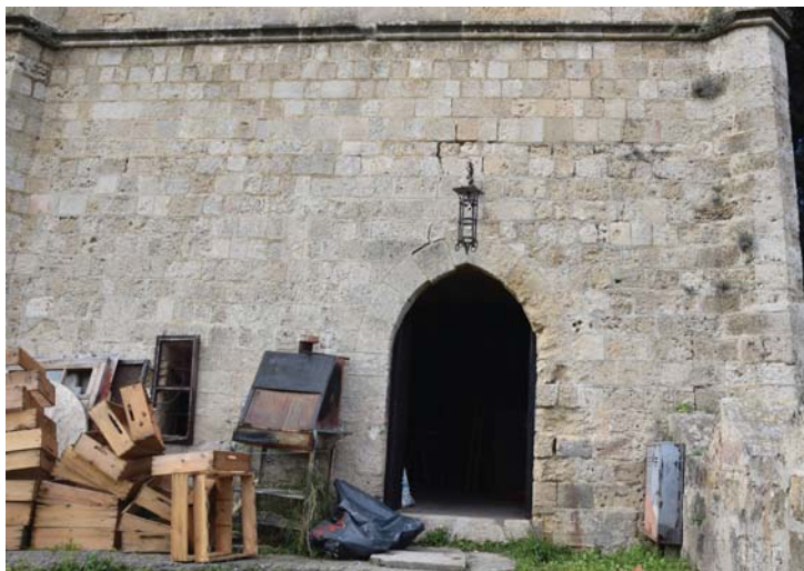
Εικόνα 54. Κτήριο Α, ανατολική όψη, ρηγμάτωση πάνω από την θύρα Θ.101
