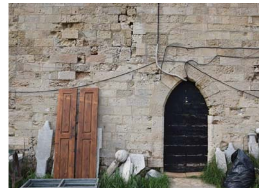
Εικόνα 80. Κτήριο Β, Διάβρωση λιθοδομής και πλαίσια ανοιγμάτων, τοπική απώλεια υλικού
