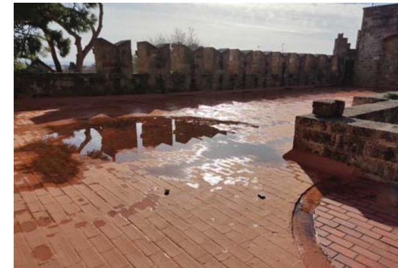
Εικόνα 74. Κτήριο Β, άποψη δώματος, λιμνάζοντα ύδατα (Φεβρουάριος 2024)
