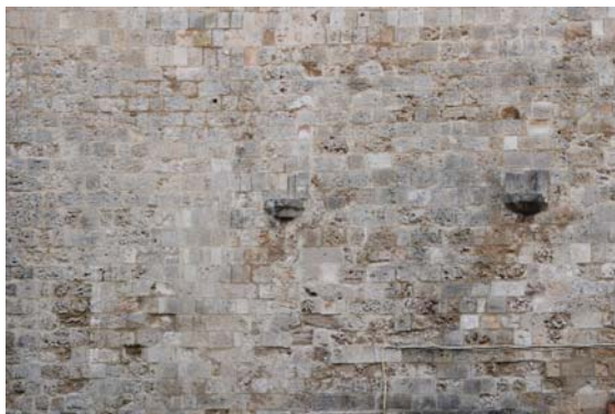
Εικόνα 77. Κτήριο Α, λεπτομέρεια λιθοδομής, δυτικός τοίχος, διάβρωση επιφάνειας λίθων και ιστορικές επεμβάσεις-αρμολογήματα
