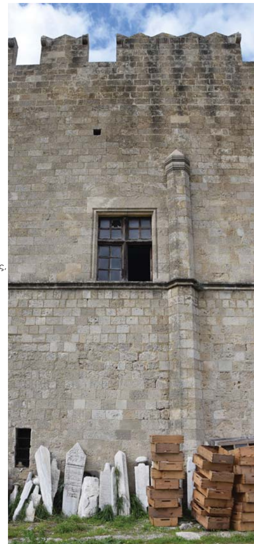
Εικόνα 60. Κτήριο Α, ρηγματώσεις στον τομέα του ανοίγματος Π.102
