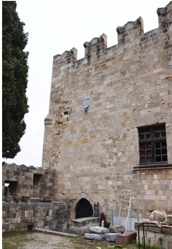
Εικόνα 61. Κτήριο Α, δυτική όψη, ρηγματώση στο βόρειο άκρο του δυτικού τοίχου
