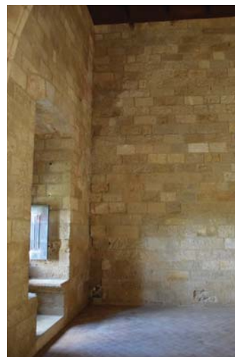
Εικόνα 56. Κτήριο Α, ανατολικός τοίχος, όροφος, ρηγμάτωση βόρειας γωνίας
