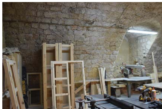
Εικόνα 81. Κτήριο Α, αίθουσα ξυλουργείου Α.102, διάβρωση λιθοδομής
