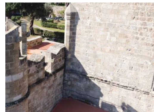
Εικόνα 84. Κτήριο Α, τοπική διάβρωση λίθινου κοσμητή
