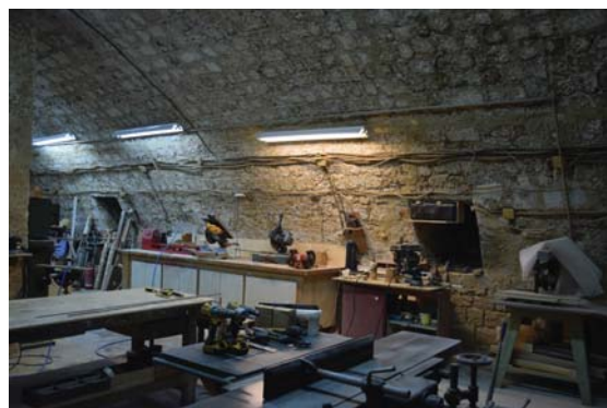
Εικόνα 82. Πρόχειρη εγκατάσταση δικτύων ΗΜ για τη χρήση του ξυλουργείου
