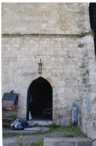
Εικόνα 55. Κτήριο Α, ανατολική όψη, ρηγμάτωση βόρειας γωνίας
