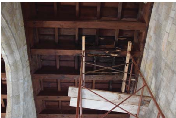
Εικόνα 68. Διάβρωση τομέα ξύλινης οροφής αίθουσας Α.101, θραύση δοκού 18, σωστική επέμβαση τοποθέτησης ικριώματος
