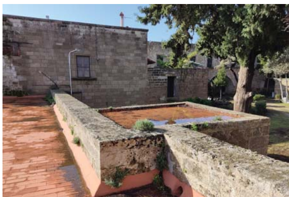
Εικόνα 75. Κτήριο Β, άποψη δώματος κλιμακοστασίου Β.102α, απουσία υδρορροής.
