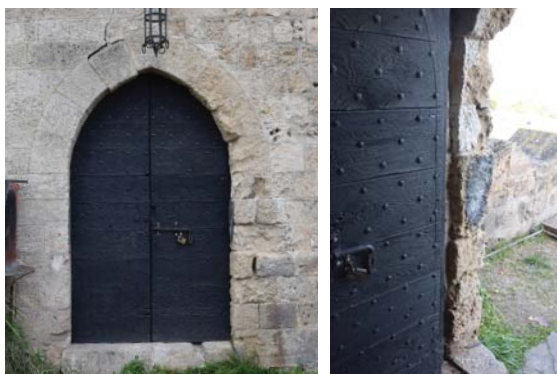
Εικόνα 79. Κτήριο Α, Διάβρωση λίθινων πλασίων θυρών (Θ.101)
