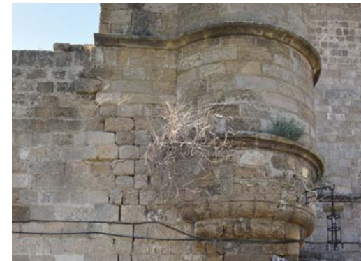
Εικόνα 83. Κτήριο Β, λεπτομέρεια ΒΑ πυργίσκου, τοπική αποδιοργάνωση-απόπλυση αρμολογήματος
