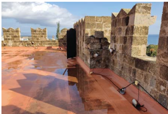
Εικόνα 70. Κτήριο Α, Γενική άποψη δώματος, λιμνάζοντα ύδατα (Φεβρουάριος 2024)
