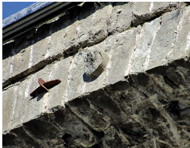
Άρπιζα και ξέρογρο διδανάγυφο σε καμάρα της γέφυρας.
