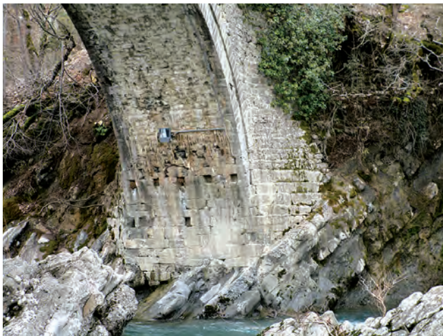
Το ανατολικό ακρόβαθρο πριν τις εργασίες αποκατάστασης.
