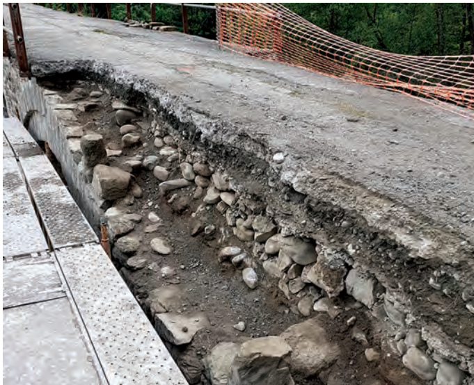
Επικάλυψη του αρχικού διδόστρωτου καταστρώματος σε δύο στρώσεις με επιχώσεις και πλάκες σκυροδέματος.
