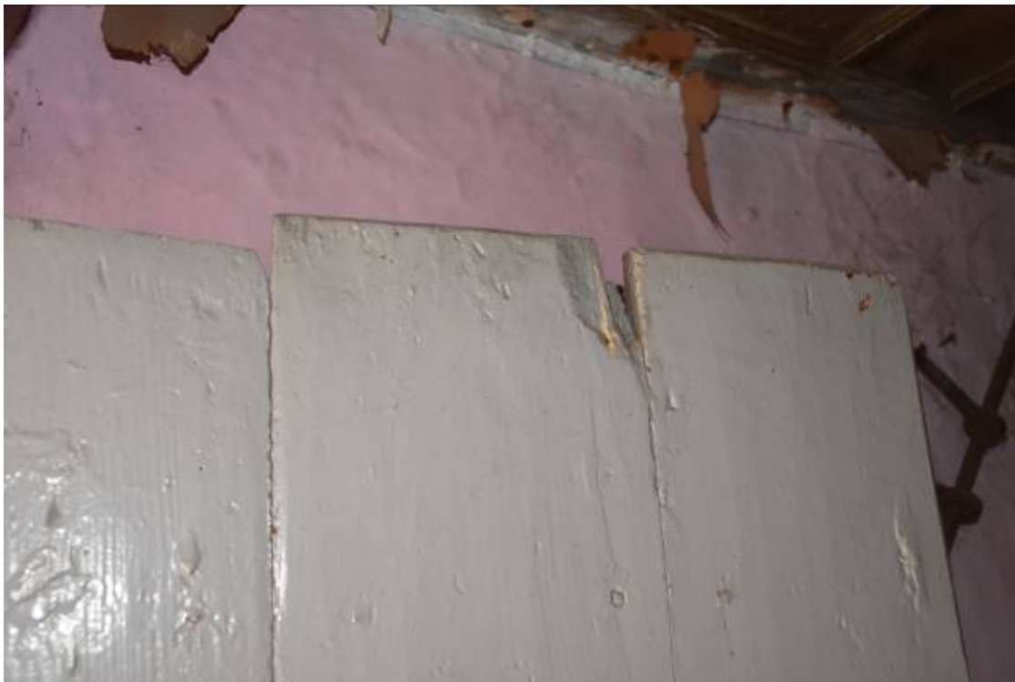
Φωτ. 220 Απώλεια ξύλινου τμήματος στη επιχρωματισμένη θύρα του ΗΜ2.
