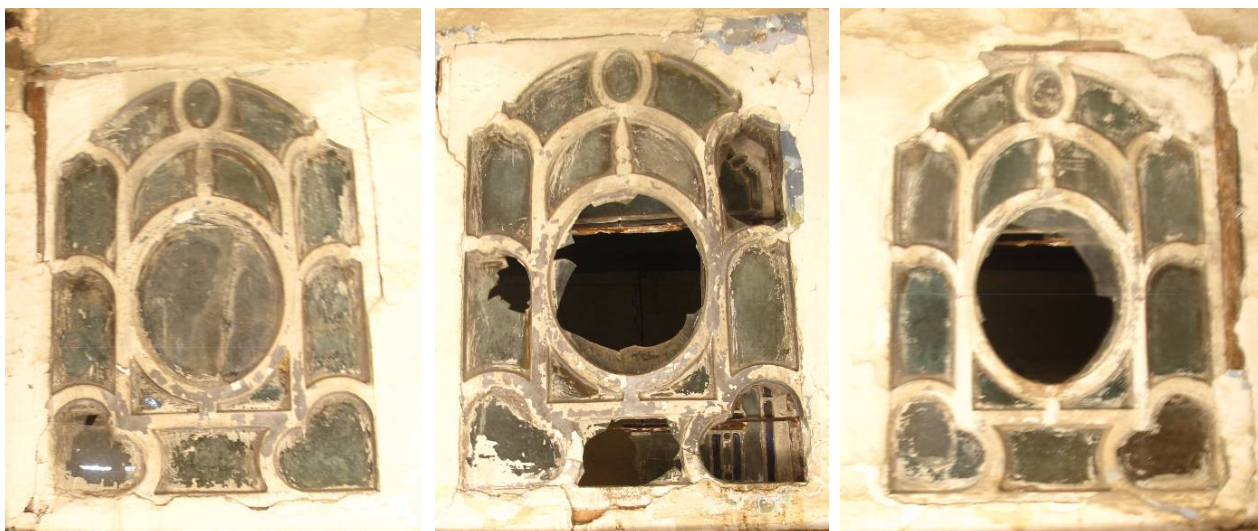
Φωτ. 462-463. Οι τρεις διπλοί γύψινοι φεγγίτες του ορτά-σοφά με διαφανές άχρωμο γυαλί. Διακρίνονται πλήθος επικαθίσεων και βαφών, ρωγμές και μεγάλες απώλειες στα υάλινα τμήματα. Ο μεταλλικός σκελετός είναι πλήρως καλυμμένος απο βαφή.
