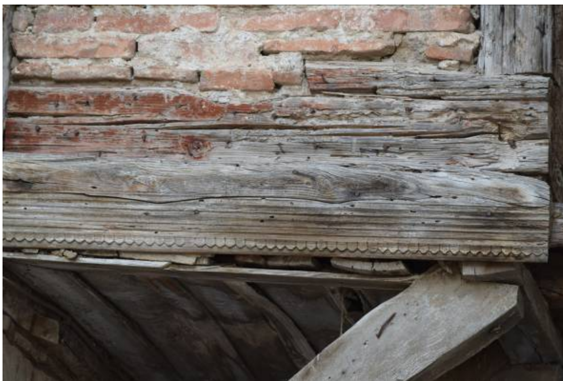
Φωτ. 299 Ρωγματώσεις, προσβολή από σηπτικούς μύκητες και απώλεια υλικού από τη δράση των ξυλοφάγων εντόμων έντομα στα ξύλα των σαχνισιών.
