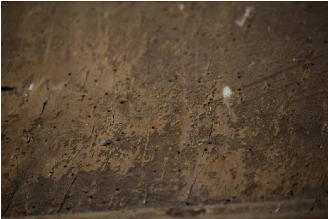
Φωτ. 250 Οπές από τη δράση των ξυλοφάγων εντόμων.
