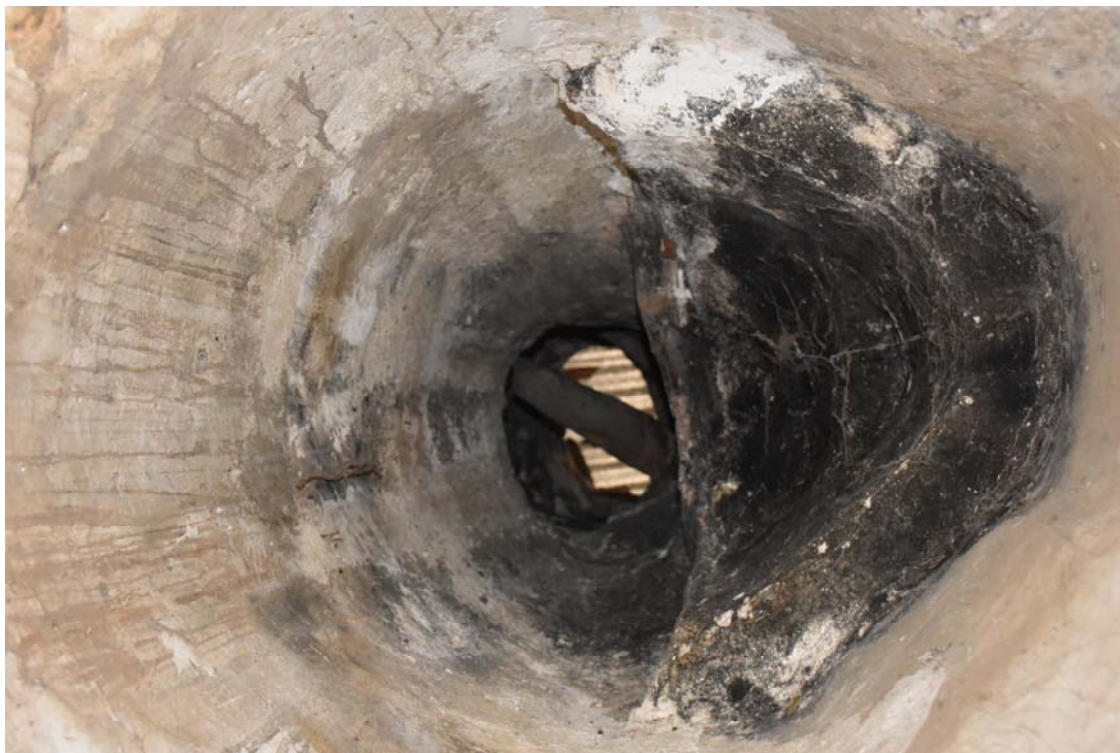
Φωτ. 327 Έντονες επικαθίσεις αιθάλης στα ανώτερα τμήματα της παρασιτιάς.
