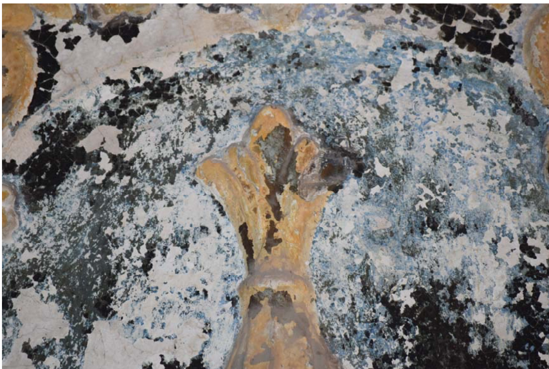
Φωτ. 325 Απώλειες, αποκολλήσεις, αποχρωματισμοί και επιχρωματισμοί στη χρωματική επιφάνεια του τζακιού.
