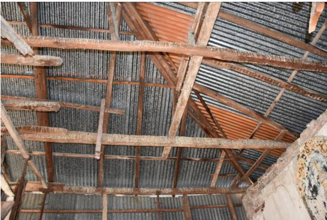
Φωτ. 288 Απώλεια ξύλων στέγης.
