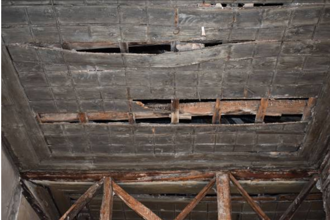
Φωτ. 179 Απώλειες, αποκολλήσεις και στρεβλώσεις ξύλινων τμημάτων και συσσώρευση φερτών υλικών και ρύπων στην πίσω πλευρά της οροφής του χαγιατιού (Α2).
