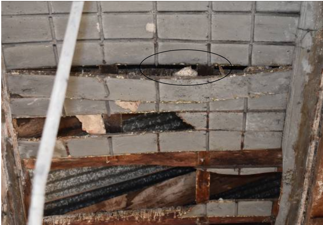
Φωτ. 178 Απώλειες, αποκολλήσεις και στρεβλώσεις ξύλινων τμημάτων και συσσώρευση φερτών υλικών και ρύπων στην πίσω πλευρά της οροφής του εξώστη (Α1).
