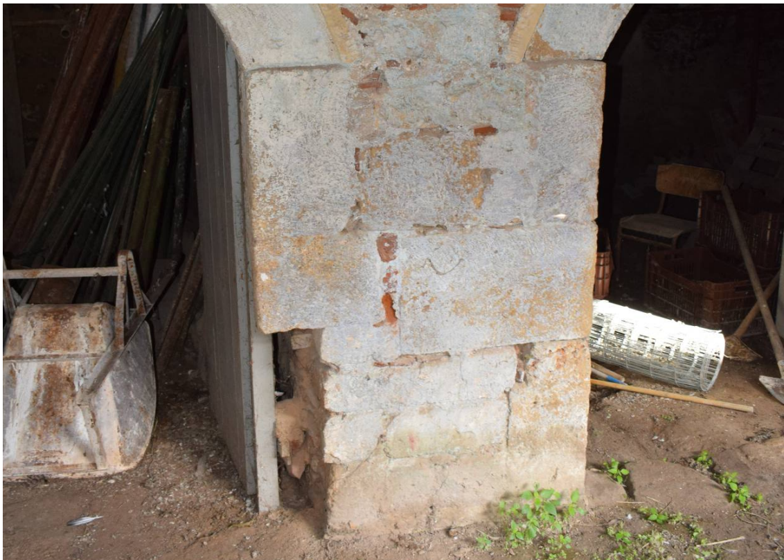
Φωτ. 444. Απώλεια των κατώτερων λίθων της μεσαίας τοξωτής θύρας του ισογείου.
