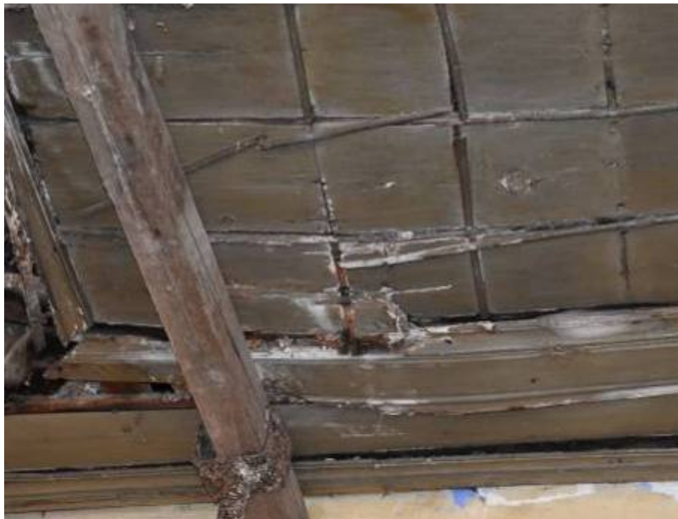
Φωτ. 184 Απώλειες, αποκολλήσεις και στρεβλώσεις ξύλινων τμημάτων στην οροφή του σοφά (Α3).
