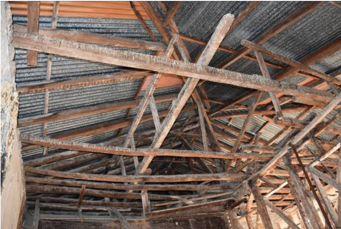
Φωτ. 287 Απώλεια ξύλων στέγης.
