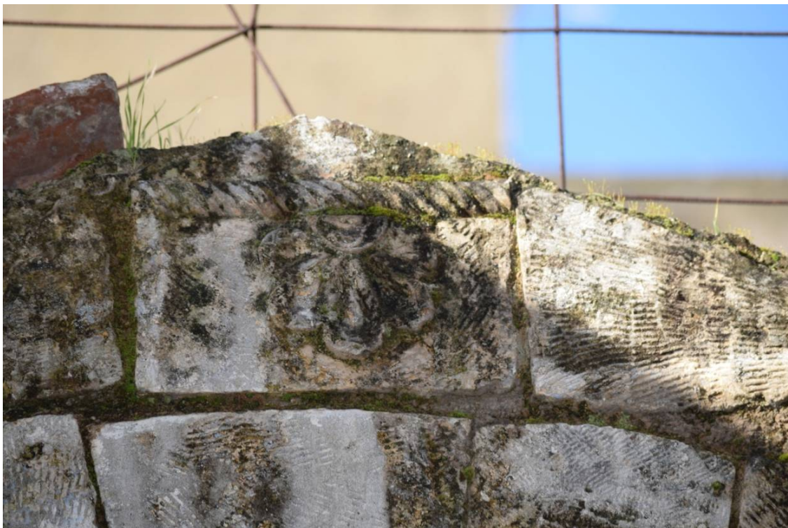
Φωτ. 403. Στην διπλή αψίδα του προαύλιου χώρου, στο ανώτερο τμήμα της, διαπιστώθηκε, εκτός απο το στρώμα βιολογικών επικαθίσεων και έντονη παρουσία φυτών με ανώτερο ριζικό σύστημα.
