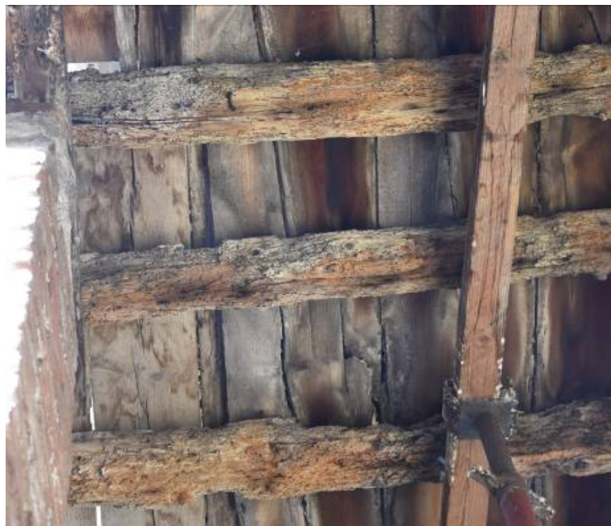
Φωτ. 306 Ρωγματώσεις, προσβολή από σηπτικούς μύκητες, απώλεια υλικού από τη δράση των ξυλοφάγων εντόμων και οξειδωμένοι μεταλλικοί σύνδεσμοι στα ξύλα των πατωμάτων.
