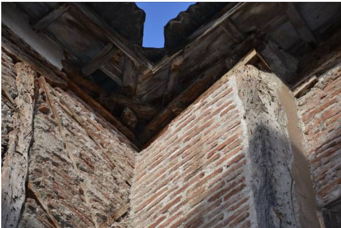
Φωτ. 309 Ρωγματώσεις, προσβολή από σηπτικούς μύκητες και απώλεια υλικού από τη δράση των ξυλοφάγων εντόμων στα ξύλα του γείσου.
