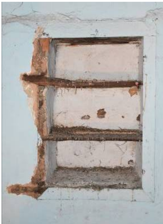
Φωτ. 109 Το ερμάριο του βόρειου τοίχου του χώρου ΗΜ3.
