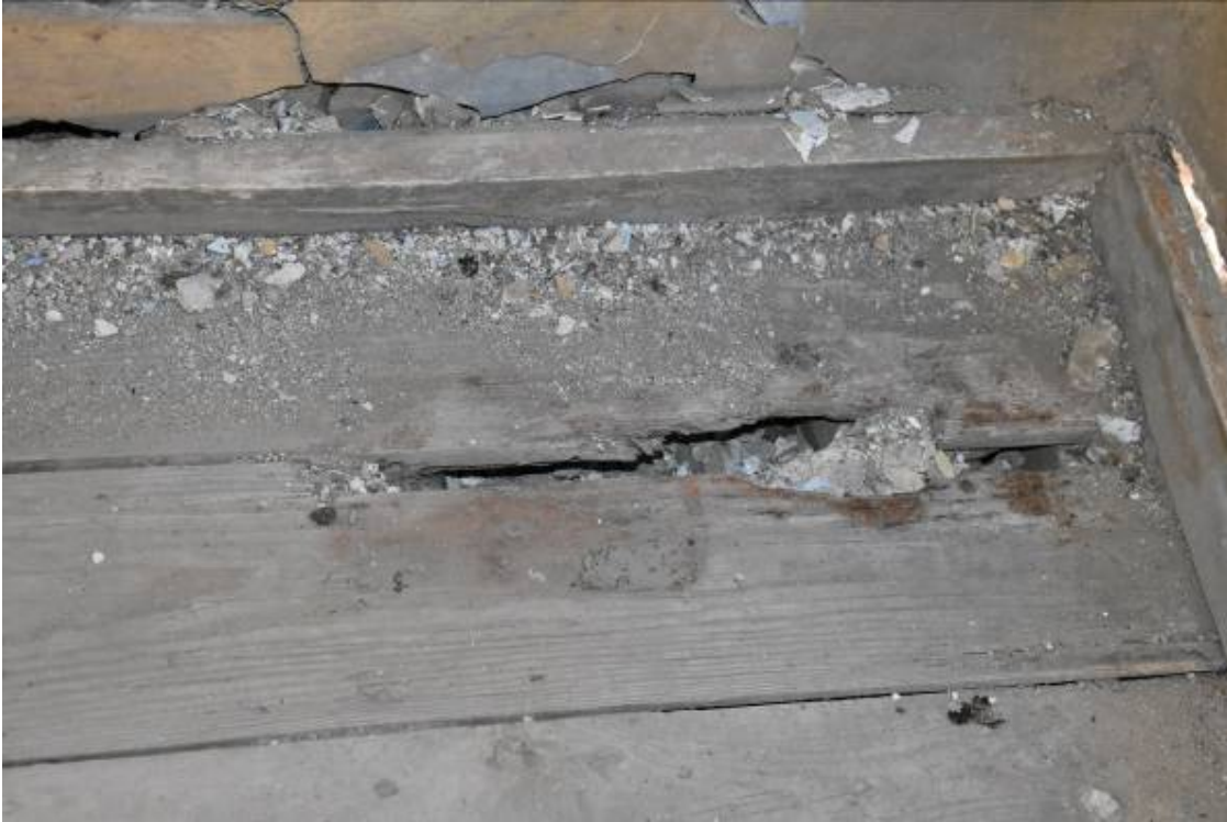
Φωτ. 209 Απώλεια ξύλινων στοιχείων και επικαθίσεις ρύπων στο δάπεδο του σοφά (Α3).
