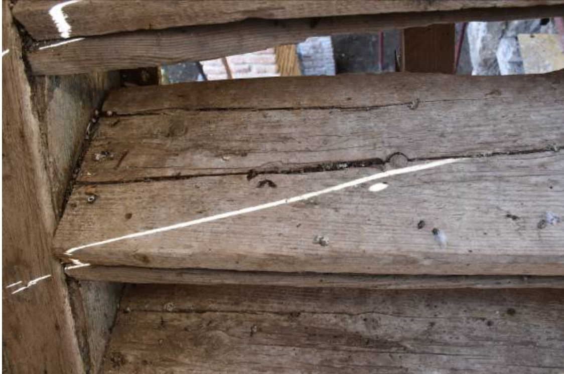
Φωτ. 283 Ρωγματώσεις του ξύλου της κλίμακας.
