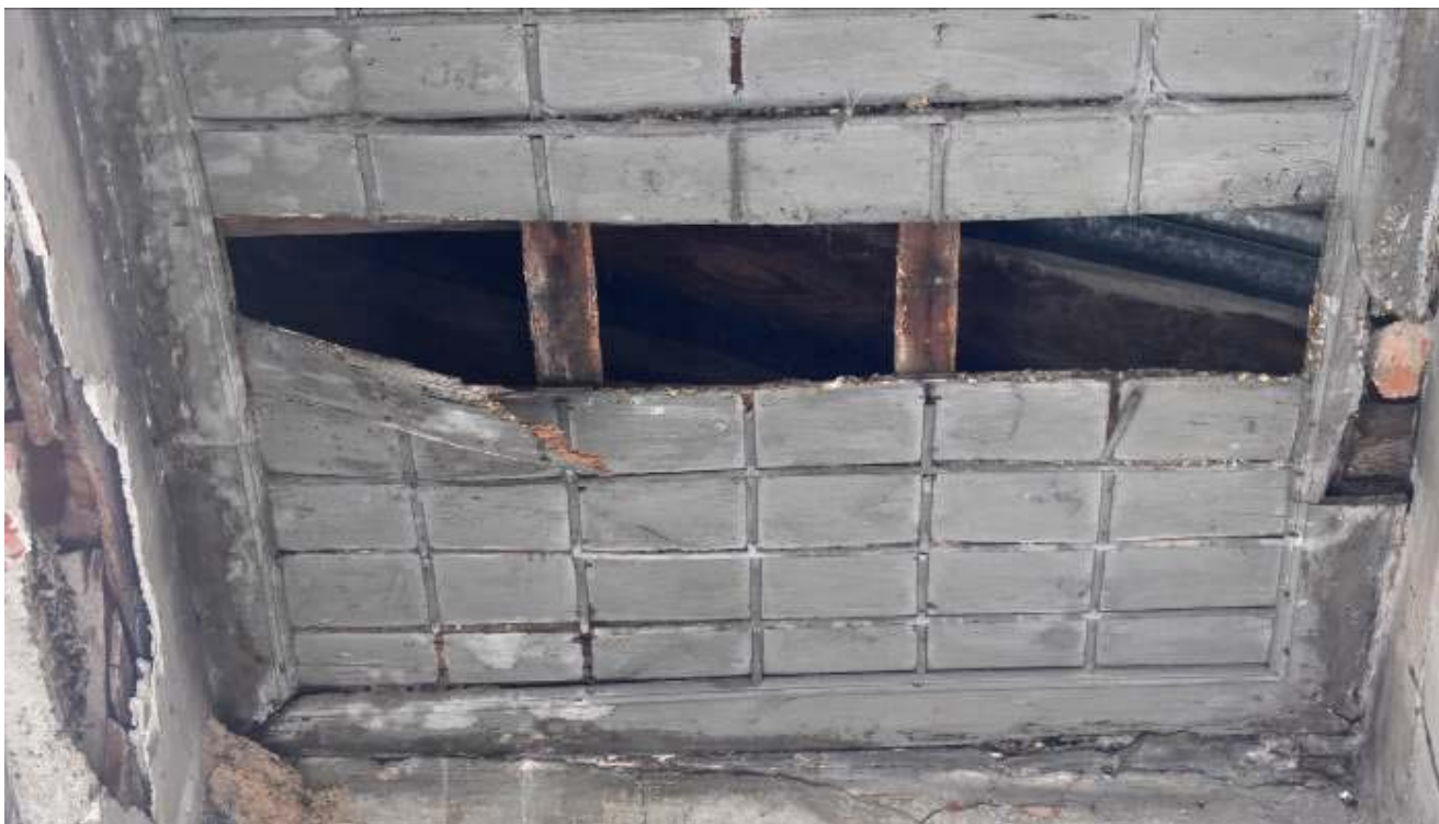
Φωτ. 180 Απώλειες και αποκολλήσεις ξύλινων τμημάτων στην οροφή του εξώστη (Α1).
