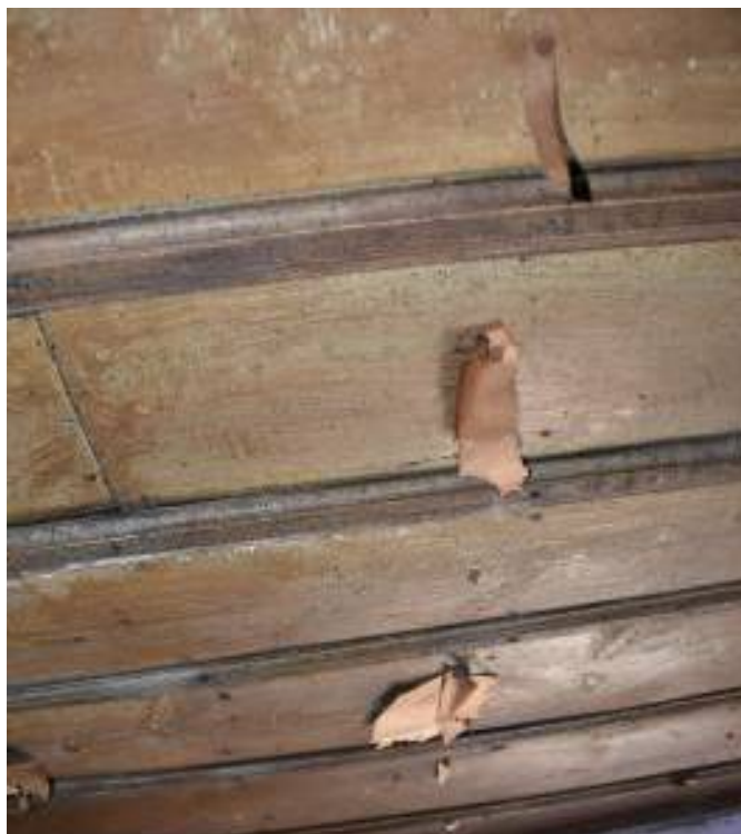
Φωτ. 206 Ίχνη επικολλημένου χαρτιού και οι οξειδωμένοι σύνδεσμοι που το συγκρατούσαν (πινέζες) στην του χώρου ΗΜ2.
