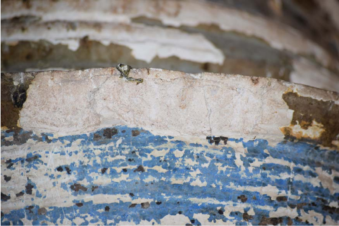
Φωτ. 320 Απώλεια τμημάτων των γύψινων διακοσμητικών του τζακιού και σαθροποίηση του γύψινου υποστρώματος.
