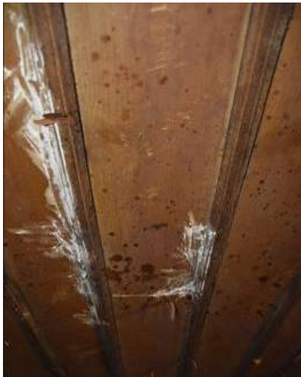
Φωτ. 205 Ρύποι και επικαθίσεις στην οροφή του χώρου ΗΜ2.
