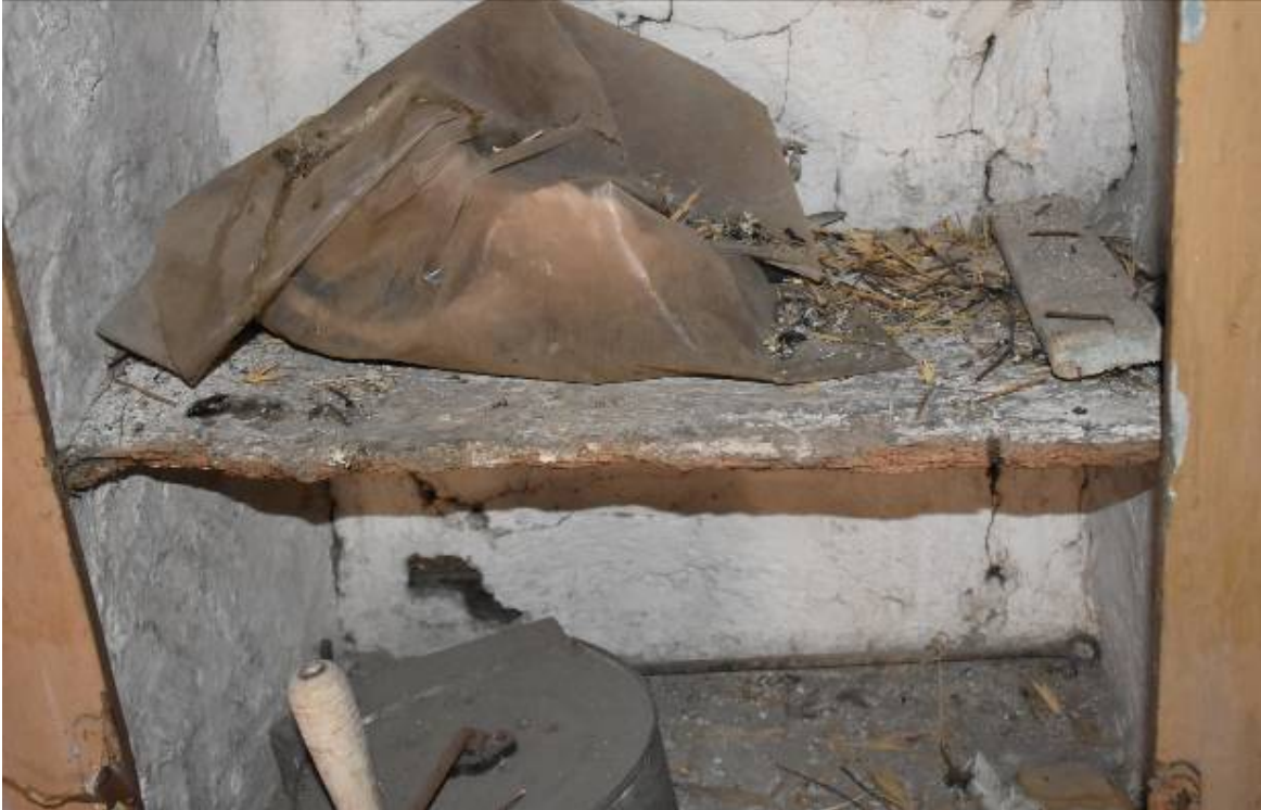
Φωτ. 270 Απώλεια υλικού από τη δράση των ξυλοφάγων εντόμων, προσβολή από σηπτικούς μύκητες σε ερμάριο του χώρου ΗΜ2 και συσσώρευση ρύπων εντός του.
