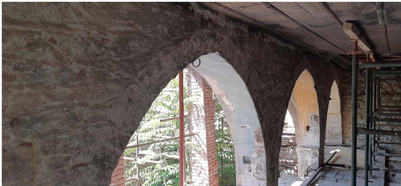
Φωτ. 334 Η νότια πλευρά της τοξοστοιχίας χώρου ΗΜ1, όπου υπάρχει πλήρης απώλεια των κονιαμάτων.
