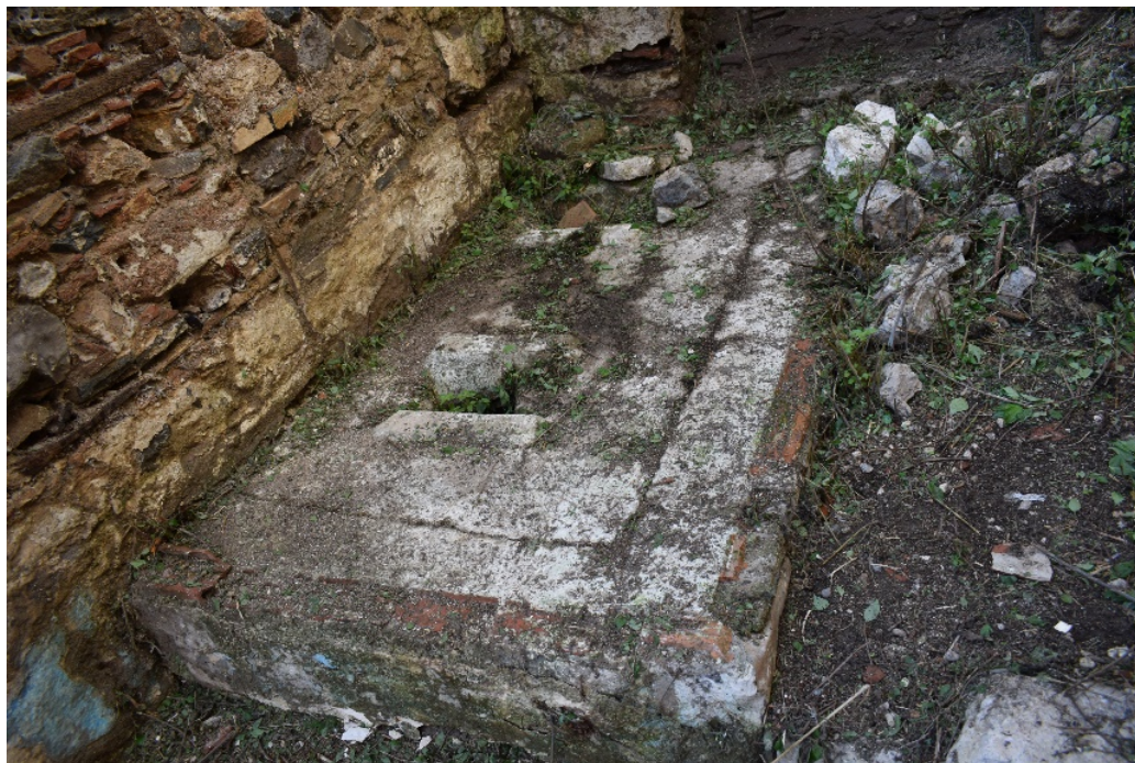
Φωτ. 367. Παραλληλόγραμμη κατασκευή σε επαφή με τον τοίχο περίφραξης πλησίον της νοτιοδυτικής γωνίας και πίσω από το διπλό αψιδωτό άνοιγμα της τοξοστοιχίας της αυλής.
