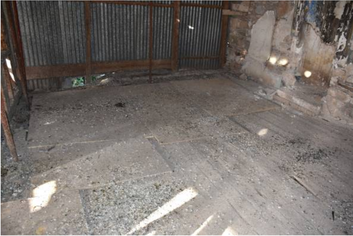
Φωτ. 76 Το δάπεδο του δυτικού οντά (Α6).
