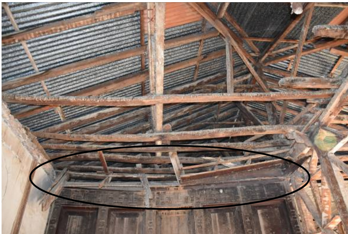
Φωτ. 176 Απώλεια του μεγαλύτερου τμήματος της οροφής του δυτικού οντά (Α6), ενώ τα τμήματα που έχουν απομείνει είναι αποκολλημένα.
