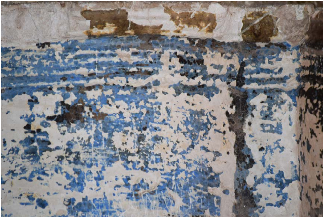
Φωτ. 324 Απώλειες, αποκολλήσεις, αποχρωματισμοί και επιχρωματισμοί στη χρωματική επιφάνεια του τζακιού.
