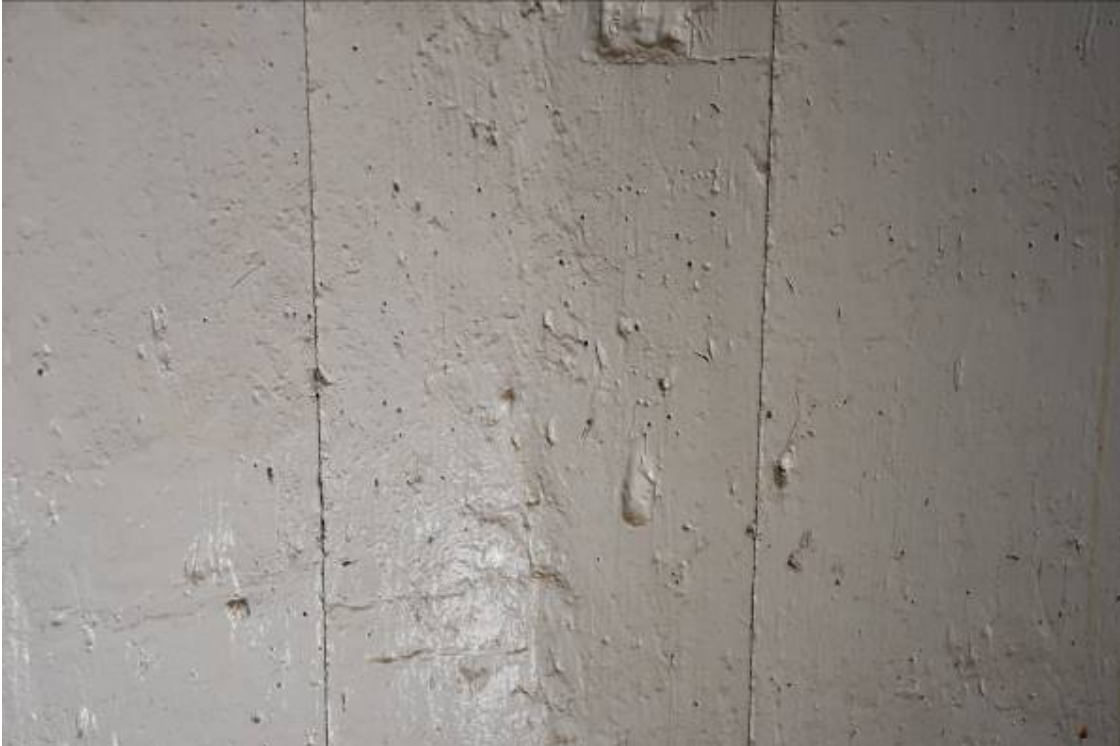
Φωτ. 225 Οπές από τη δράση ξυλοφάγων εντόμων και εκδορές στη θύρα του χώρου ΗΜ2.
