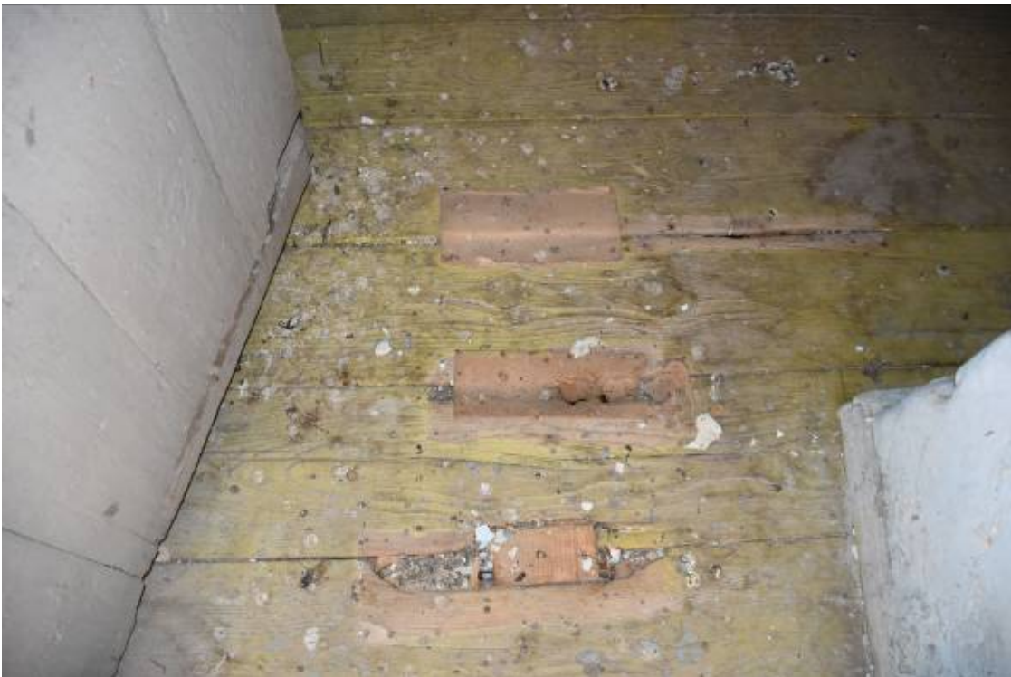
Φωτ. 216 Απώλειες ξύλινων στοιχείων και τοποθέτηση μικρών τμημάτων νέου ξύλου στο επιχρωματισμένο δάπεδο του χώρου ΗΜ3.
