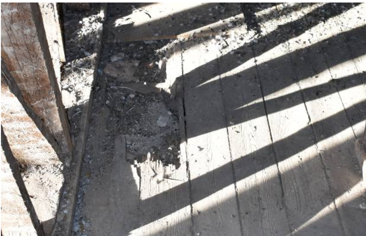
Φωτ. 212 Απώλεια ξύλινων στοιχείων και επικαθίσεις ρύπων στο δάπεδο του δυτικού οντά (Α6).
