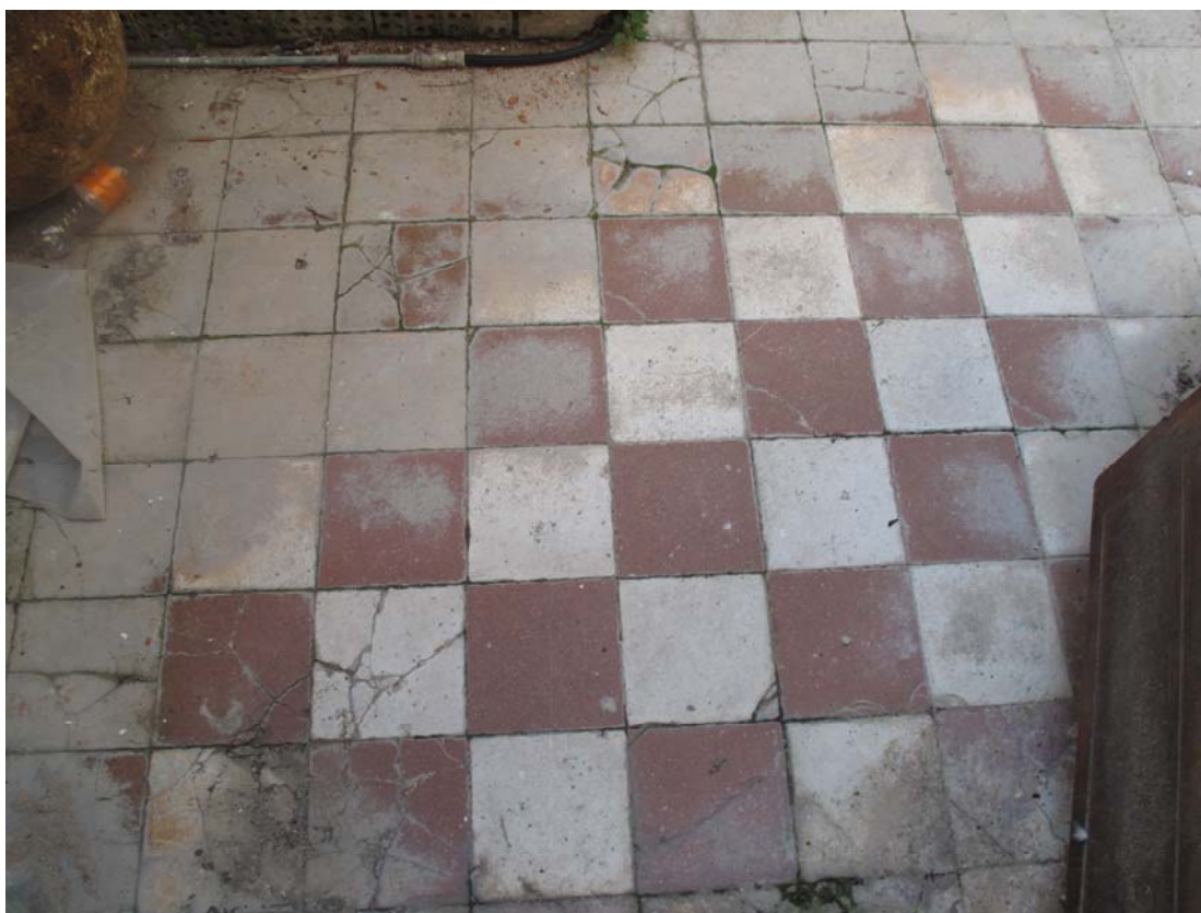
Φωτ. 469. Τιμμεντοπλακίδια στην είσοδο από την αυλόθυρα. Επιφάνεια καλυμμένη από επικαθίσεις, σε λεπτότερα ή παχύτερα στρώματα. Σημειακές επικαθίσεις αλάτων που δίνουν την εικόνα μιας «αδρής» επιφάνειας. Διάνοιξη των αρμών με απώλεια υλικού. Έντονες μηχανικές φθορές, όπως ρωγμές και ρηγματώσεις. Αποτμήσεις και απολεπίσεις, ειδικά στις ακμές τους και στους αρμούς.
