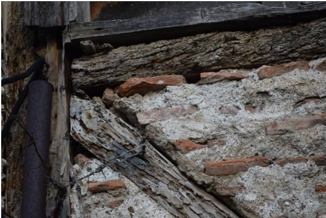
Φωτ. 296 Ρωγματώσεις, προσβολή από σηπτικούς μύκητες, απώλεια υλικού από τη δράση των ξυλοφάγων εντόμων και οξειδωμένοι μεταλλικοί σύνδεσμοι στα ξύλα της των ξυλόπηκτων τοίχων.
