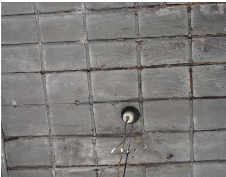
Φωτ. 196 Τοποθέτηση καλωδιώσεων για την παροχή ηλεκτρικού ρεύματος στην οροφή του χαγιατιού (A2).
