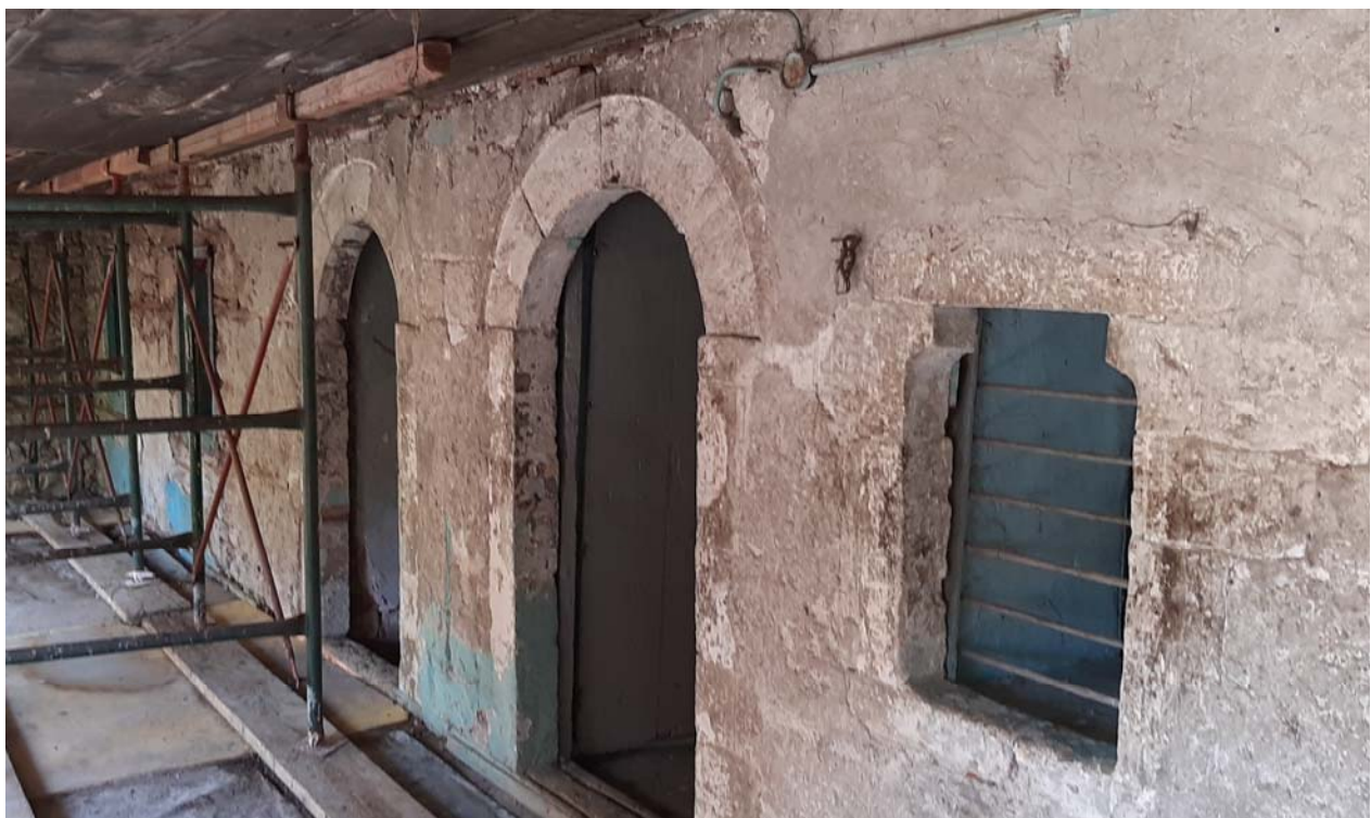
Φωτ. 143 Ο βόρειος τοίχος του χώρου ΗΜ1, όπου σώζεται το αυθεντικό εσωτερικό κονίαμα εξομάλυνσης της τοιχοποιίας..
