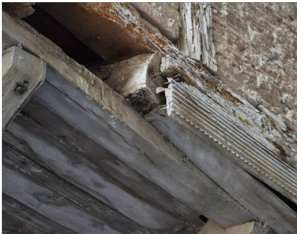
Φωτ. 298 Απώλεια διακοσμητικού στοιχείου και οξειδωμένοι μεταλλικοί σύνδεσμοι στα ξύλα των σαχνισιών.
