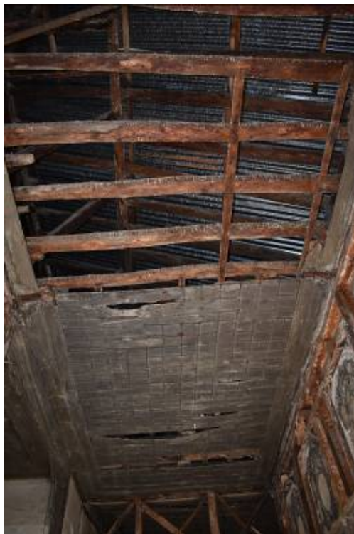
Φωτ. 175 Απώλεια μεγάλου τμήματος της οροφής του χαγιατιού (Α2).
