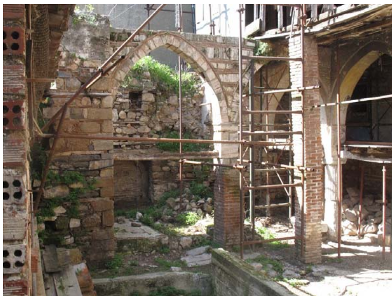
Φωτ. 362. Άποψη του διατηρημένου τμήματος της τοξοστοιχίας σχήματος 'Γ' στην αυλή της οικίας.
