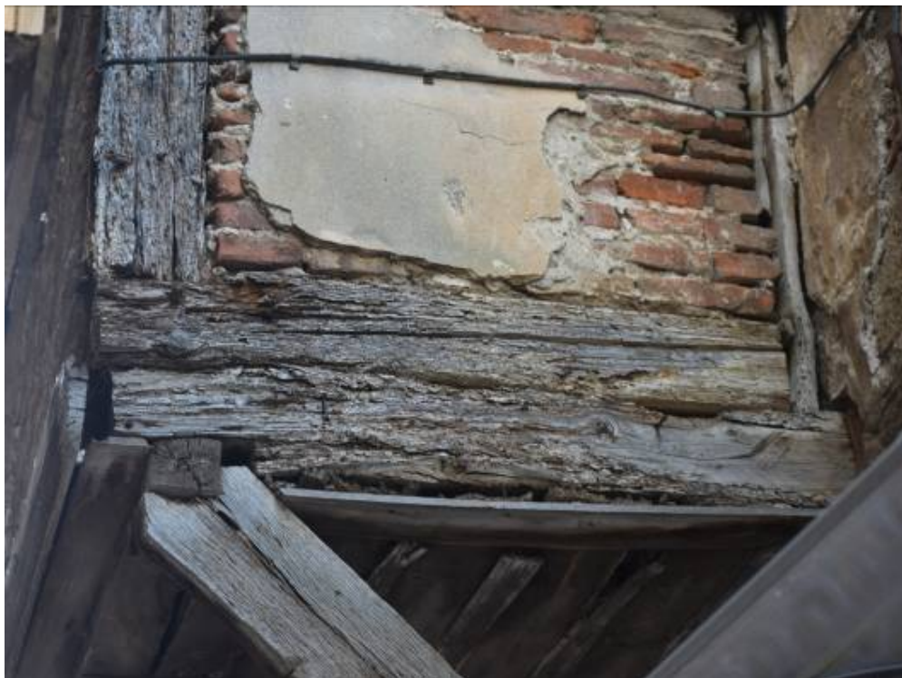
Φωτ. 302 Ρωγματώσεις, προσβολή από σηπτικούς μύκητες, απώλεια υλικού από τη δράση των ξυλοφάγων εντόμων και οξειδωμένοι μεταλλικοί σύνδεσμοι στα ξύλα των σαχνισιών.
