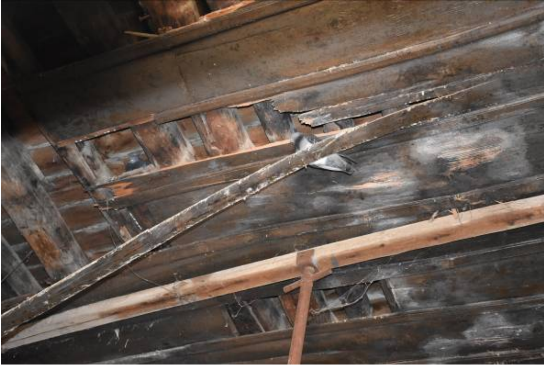
Φωτ. 177 Απώλεια τμημάτων και αποκολλημένα στοιχεία στην οροφή του χώρου ΗΜ4.
