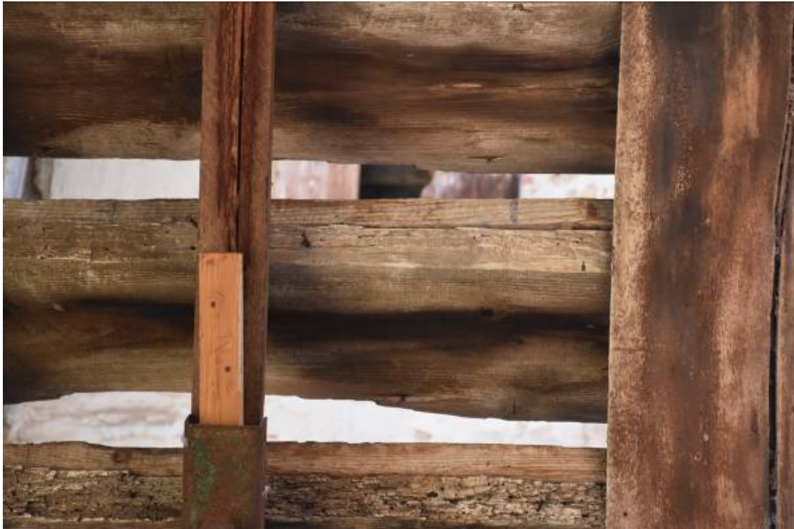
Φωτ. 281 Ρωγματώσεις, διάβρωση και προσβολή της σκάλας από σηπτικούς μύκητες και ξυλοφάγα έντομα.
