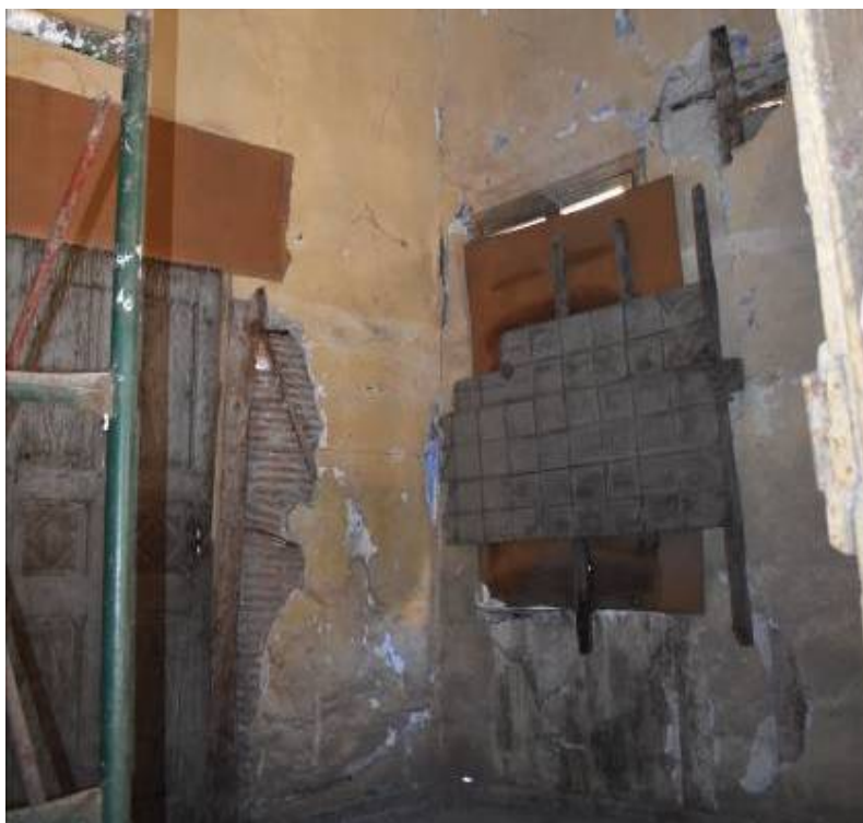
Φωτ. 194 Χρήση τμήματος οροφής για τη σφράγιση ανοίγματος στο χώρο του σοφά (Α3).
