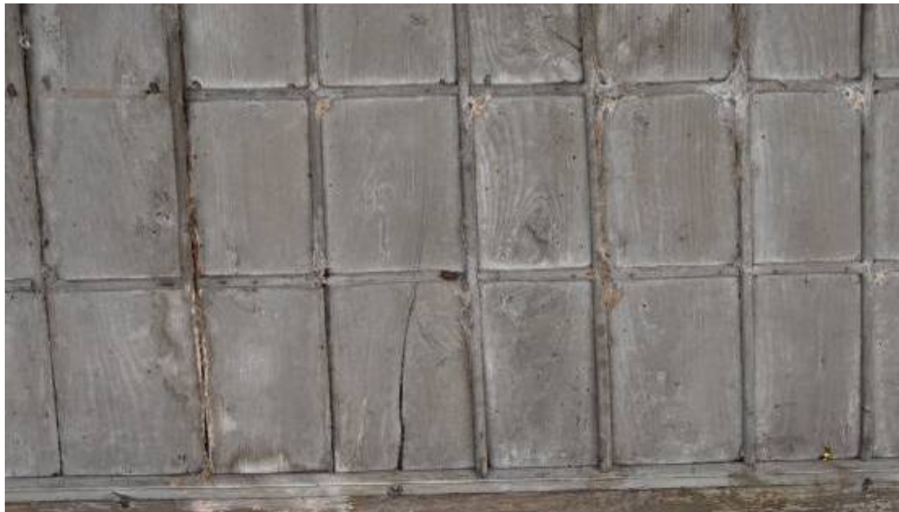
Φωτ. 187 Ρωγμάτωση και απώλειες ξύλινων τμημάτων στην οροφή του χαγιατιού (A2).
