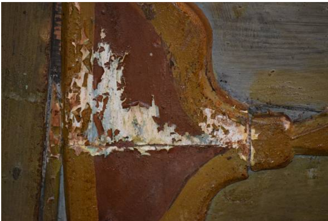
Φωτ. 202 Απώλειες χρωματικού διακόσμου και αποκολλημένο χρωματικό στρώμα στην οροφή του ανατολικού οντά (Α4). Επίσης διακρίνεται υποκείμενος χρωματικός διάκοσμος κάτω από το αποκολλημένο υπερκείμενο χρωματικό στρώμα.
