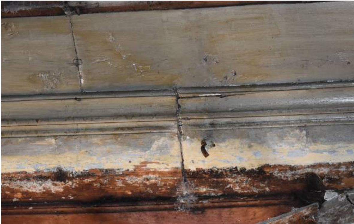
Φωτ. 197 Οξειδωμένος μεταλλικός σύνδεσμος συγκράτησης σωληνώσεων στην οροφή του σοφά (Α3).
