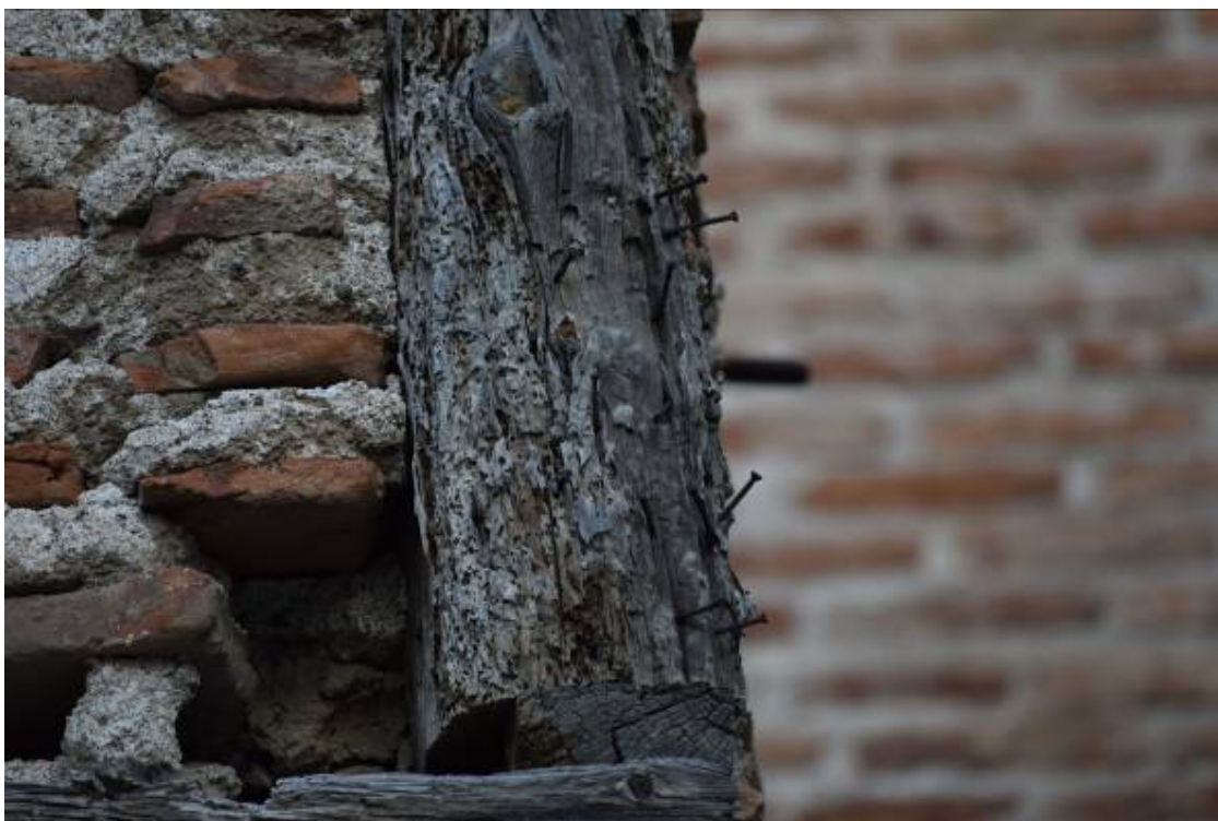
Φωτ. 297 Ρωγματώσεις, προσβολή από σηπτικούς μύκητες και ξυλοφάγα έντομα και οξειδωμένοι μεταλλικοί σύνδεσμοι και στα ξύλα της των ξυλόπηκτων τοίχων.
