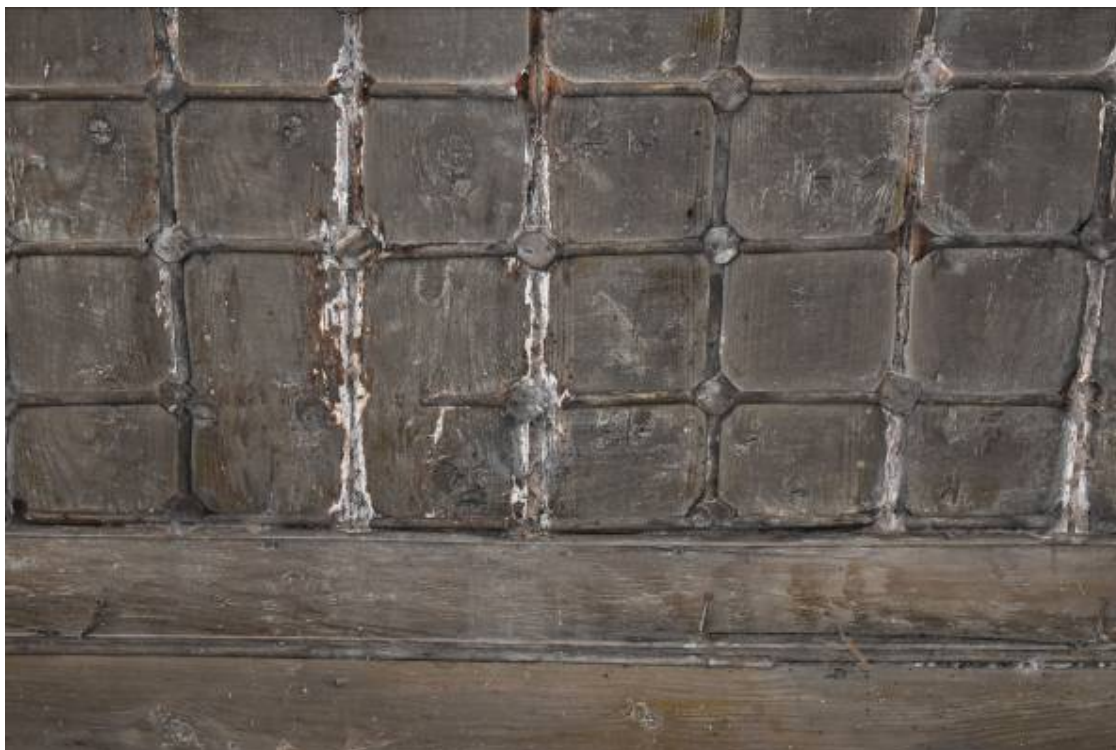
Φωτ. 188 Απώλειες ξύλινων τμημάτων στην οροφή του χαγιατιού (A2), μπροστά από την είσοδο του ορτά-σοφά.
