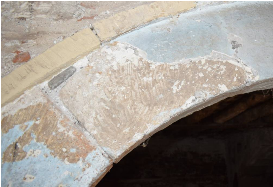
Φωτ. 433.επτομέρεια απο τους λίθους και το κατεστραμμένο κονίαμα.
