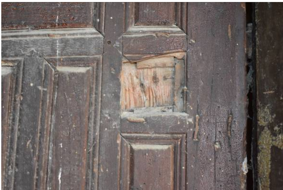
Φωτ. 219 Απώλεια ξύλινου στοιχείου στη θύρα του ορτά-σοφά (Α5).
