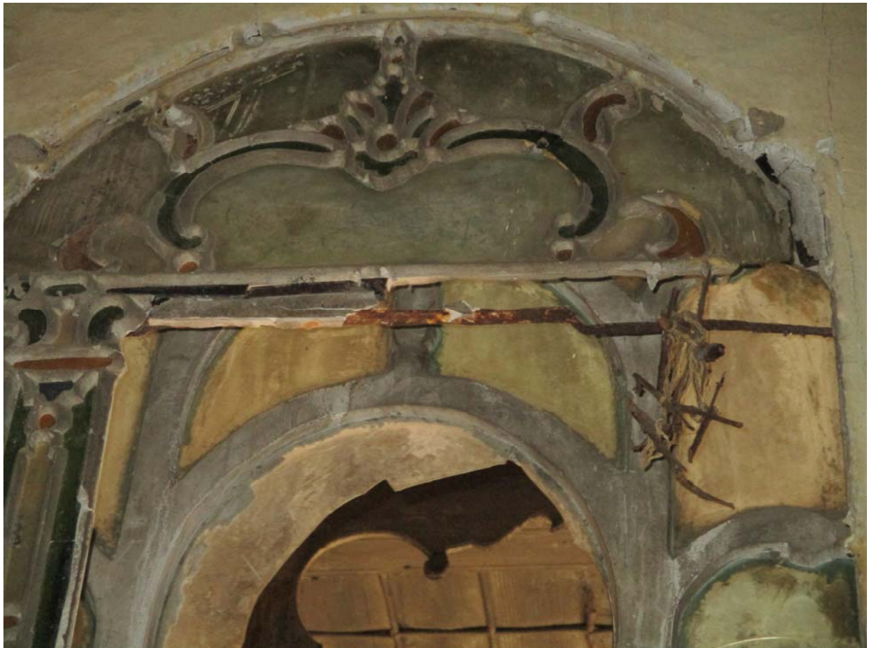
Φωτ. 466. Λεπτομέρεια της κατάστασης διατήρησης του φεγγίτη, σπασμένη υαλώδης επιφάνεια, επικαθίσεις χρώματος, οξειδωμένα μεταλλικά στοιχεία.
