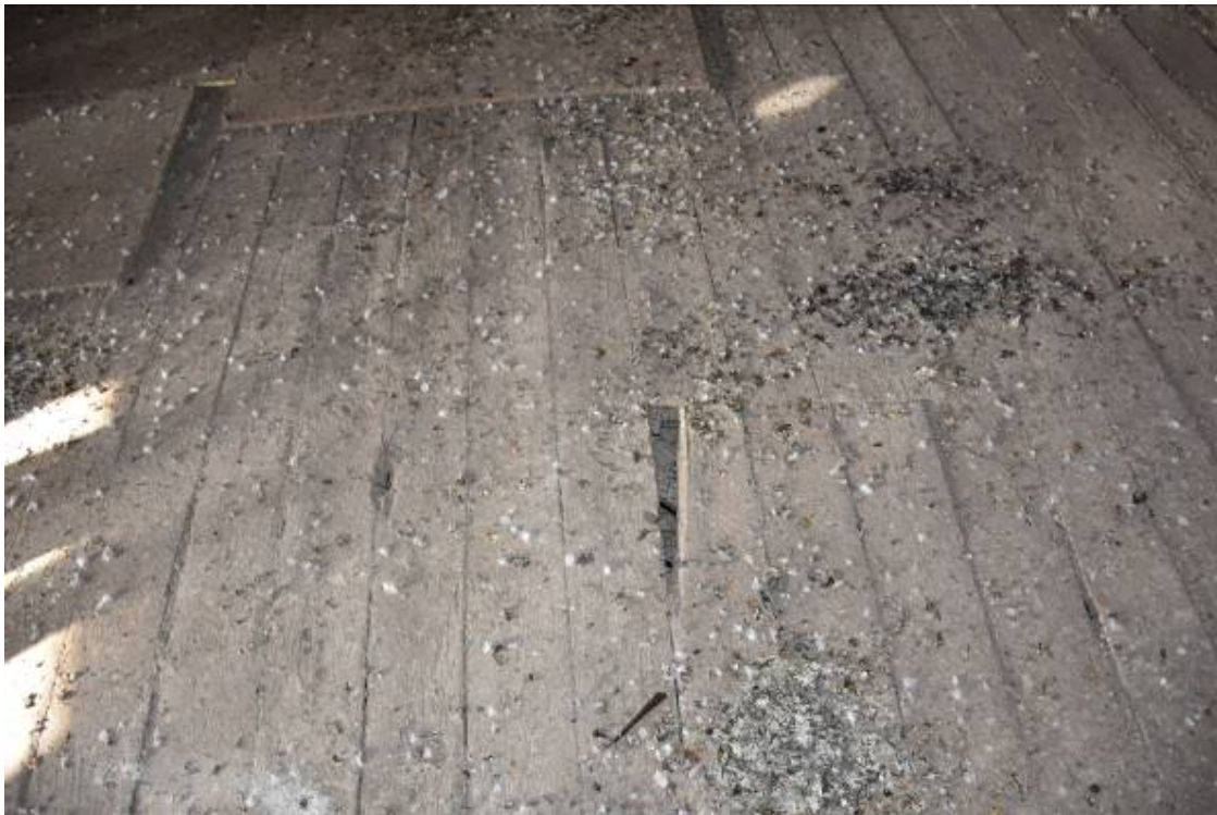
Φωτ. 213 Απώλεια ξύλινων στοιχείων και επικαθίσεις ρύπων στο δάπεδο του δυτικού οντά (Α6).
