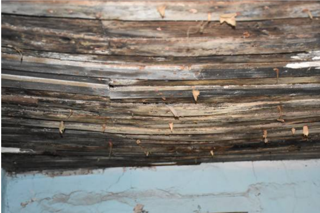
Φωτ. 191 Στρεβλώσεις, αποκολλήσεις και προσβολή από σηπτικούς μύκητες στην οροφή του χώρου ΗΜ3.
