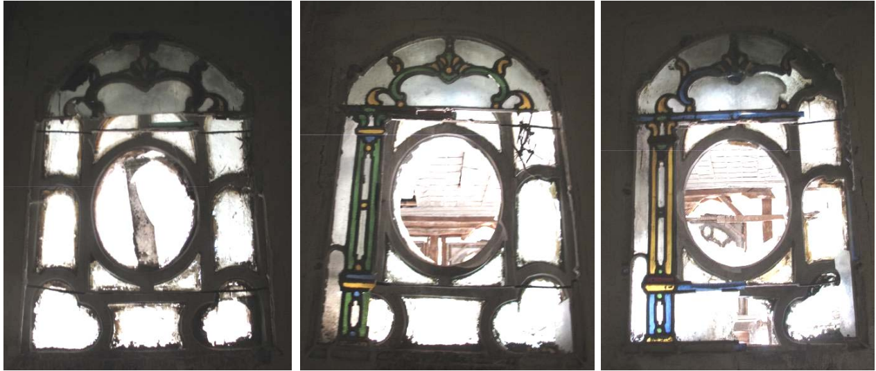
Φωτ. 464-465. Τρεις απο τους πέντε μονούς γύψινους φεγγίτες με έγχρωμο και άχρωμο γυαλί. Διακρίνονται πλήθος επικαθίσεων και βαφών, ρωγμές και μεγάλες απώλειες στα υάλινα τμήματα. Ο μεταλλικός σκελετός είναι πλήρως καλυμμένος απο βαφή.
