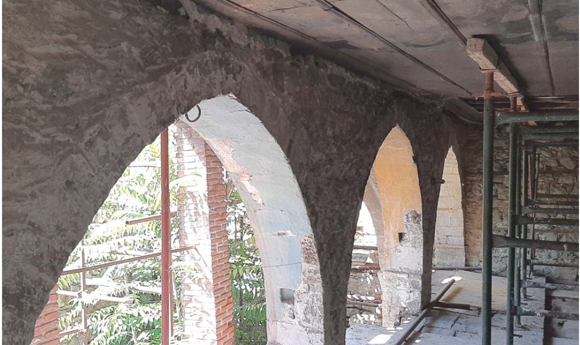
Φωτ. 428. Χρωματιστό κονίαμα τοπικά κατεστραμμένο, διακρίνεται στις τοξωτές καμάρες στον ημιυπαίθριο χώρο του μεσοπατώματος, το οποίο έχει καταστραφεί λόγω κακής συντήρησης και της γενικότερης κακής κατάστασης του κτηρίου.
