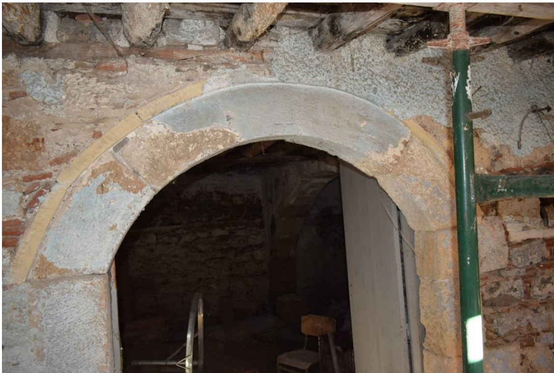
Φωτ. 432. Επιφανειακό επίστρωμα κονιάματος (βαφή γαλάζιου χρώματος) στο τοξωτό ανώφλι των θυρών του μεσοπατώματος, που έχει μερικώς φθαρεί και δημιουργεί αρνητικό αισθητικό αποτέλεσμα.
