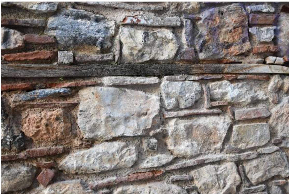
Φωτ. 291 Ρωγματώσεις, προσβολή από σηπτικούς μύκητες και απώλεια υλικού από τη δράση των ξυλοφάγων εντόμων στη ξυλοδεσιά της τοιχοποιίας.
