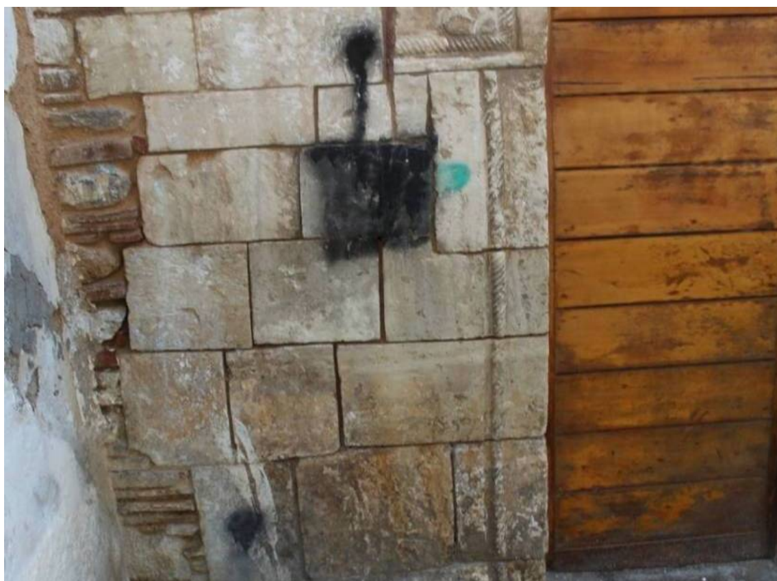
Φωτ. 450-451. Ανθρώπινος βανδαλισμός με τη μορφή γκράφιτι στην εξωτερική πλευρά του κτίσματος και συγκεκριμένα στους λίθους της αυλόθυρας.
