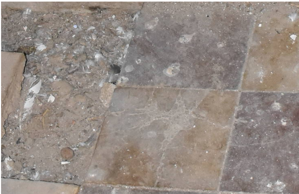
Φωτ. 475. Λεπτομέρεια της κατάστασης διατήρησης. Πλήθος επικαθίσεων, και περιττωμάτων πτηνών. Σημειακές κηλίδες ελαιώδους υφής και επικαθίσεις αλάτων. Απώλεια πλακιδίων.
