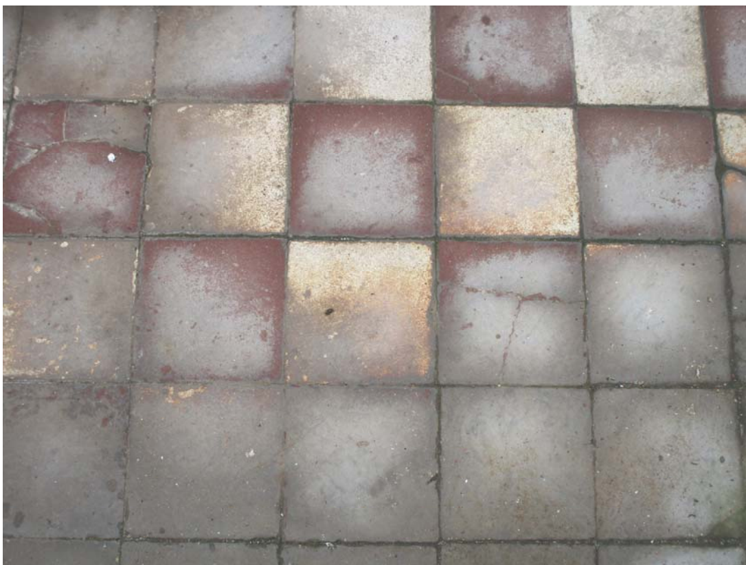
Φωτ. 470. Λεπτομέρεια της κατάστασης διατήρησης των πλακιδίων της εισόδου.
