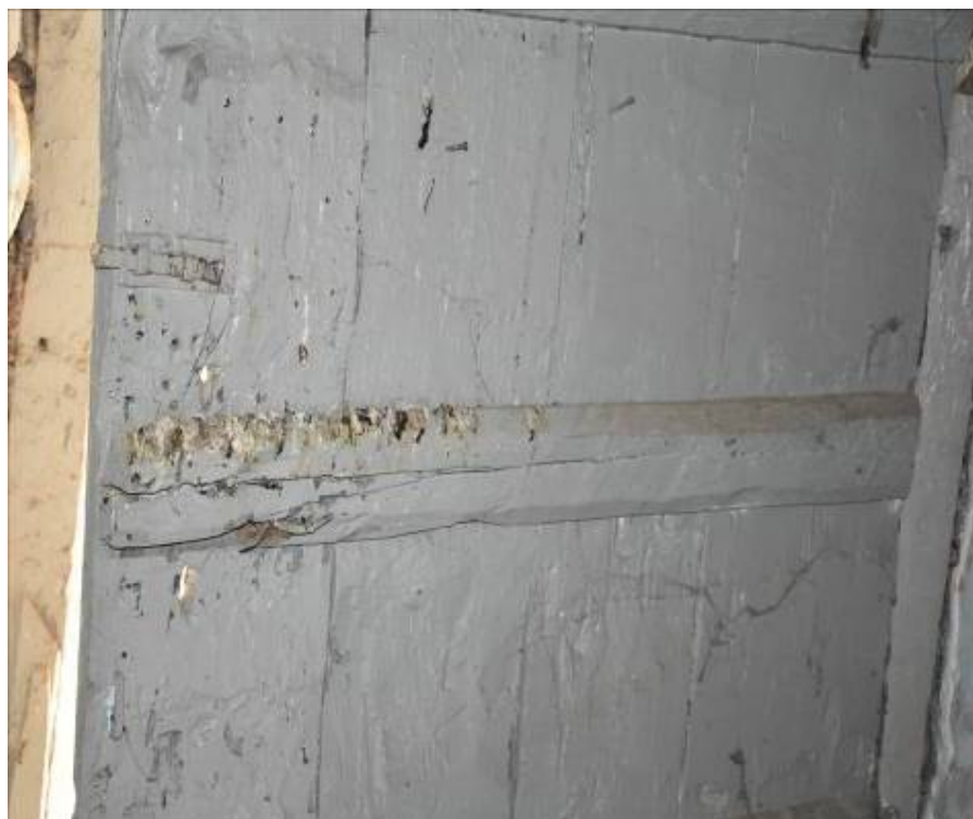
Φωτ. 238 Περιπτώματα πτηνών στη θύρα του χώρου ΗΜ3.
