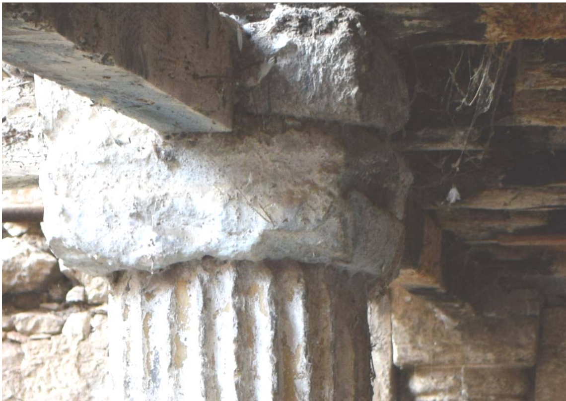
Φωτ. 417. Στρώμα περιβαλλοντικών επικαθίσεων, περιπτώματα πτηνών και στρώμα κονιάματος και βαφής στο λίθινο κιονόκρανο της αριστερής κολώνας του ισογείου.
