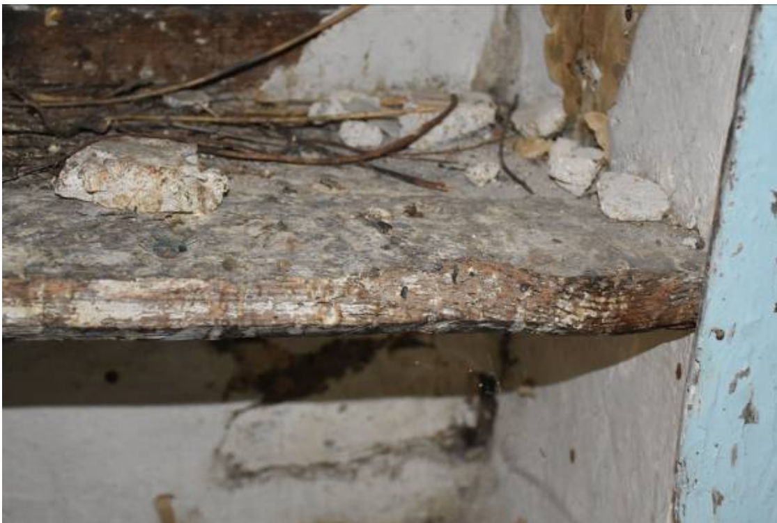
Φωτ. 271 Απώλεια υλικού από τη δράση των ξυλοφάγων εντόμων, προσβολή από σηπτικούς μύκητες σε ερμάριο του χώρου ΗΜ2 και συσσώρευση ρύπων εντός του.
