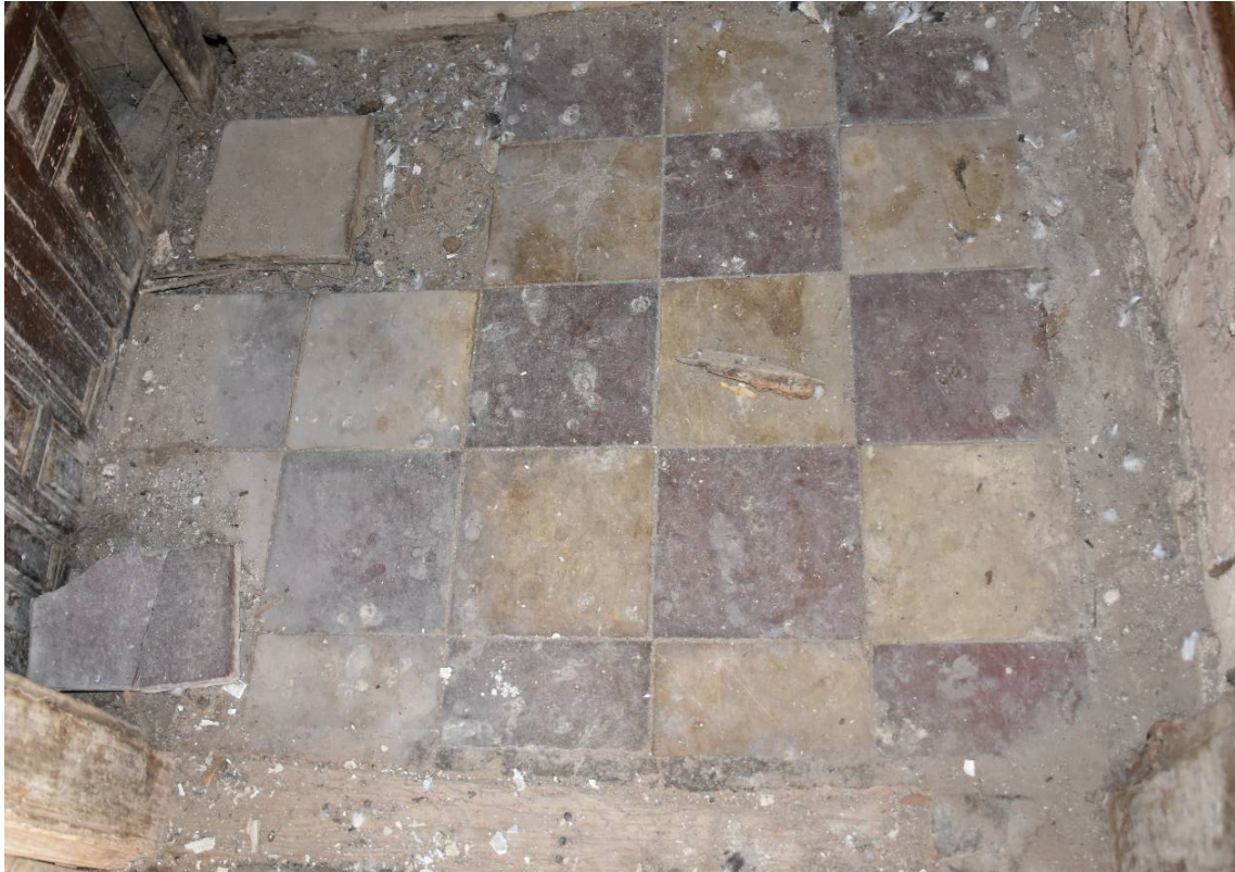
Φωτ. 474. Τσιμεντοπλακίδια στο πλατύσκαλο του ορόφου. Επιφάνεια καλυμμένη από πλήθος επικαθίσεων, και περιττωμάτων πτηνών. Σημειακές κηλίδες ελαιώδους υφής και επικαθίσεις αλάτων. Μηχανικές φθορές, όπως ρωγμές και ρηγματώσεις στα άκρα της κατασκευής. Αποκόλληση πλακιδίων και απώλεια 4 τεμαχίων.
