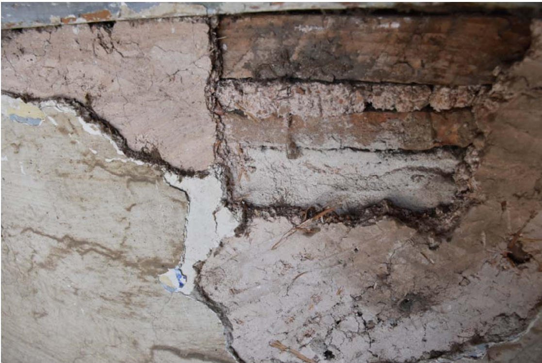
Φωτ. 329 Απώλεια κονιάματος μαζί με τη ζωγραφικό στρώμα, ρωγματώσεις, αποσπασμένο και κονιορτοποιημένο κονίαμα.
