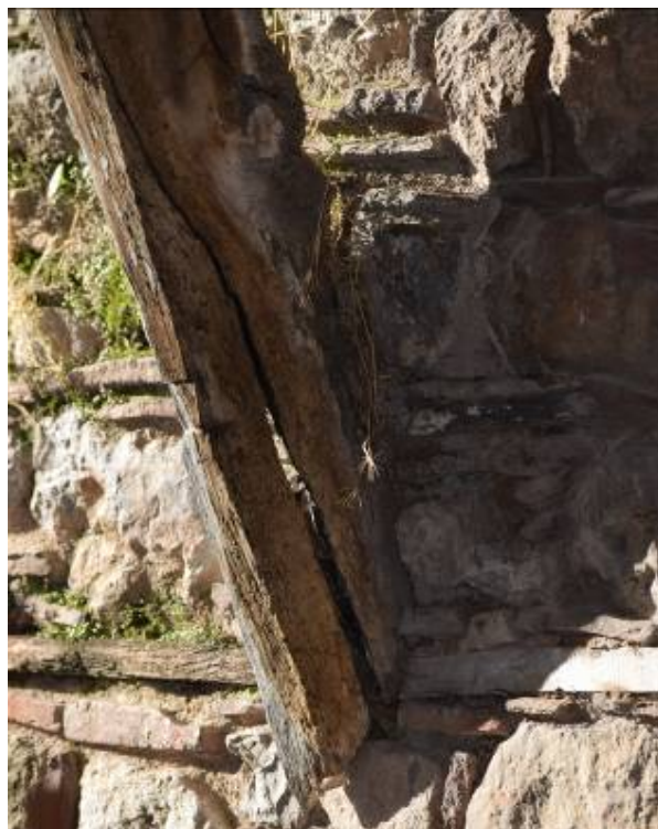
Φωτ. 301 Ρωγματώσεις και προσβολή από σηπτικούς μύκητες και ξυλοφάγα έντομα στα ξύλα των σαχνισιών.
