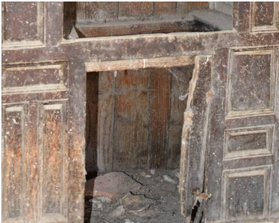
Φωτ. 243 Απώλειες ξύλινων τμημάτων στη μουσάντρα του δυτικού οντά (A6).
