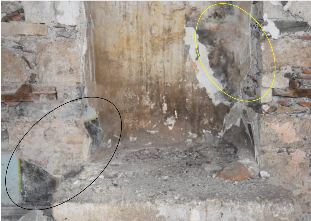
Φωτ. 137 Εντός μαύρου πλαισίου το νεότερο ζωγραφικό στρώμα της παρασιτιάς που συνεχίζει και στον τοίχο. Εντός κίτρινου πλαισίου η αυθεντική επιφάνεια της παρασιτιάς, όπου διακρίνονται τα ίχνη από τη χρήση του τζακιού.
