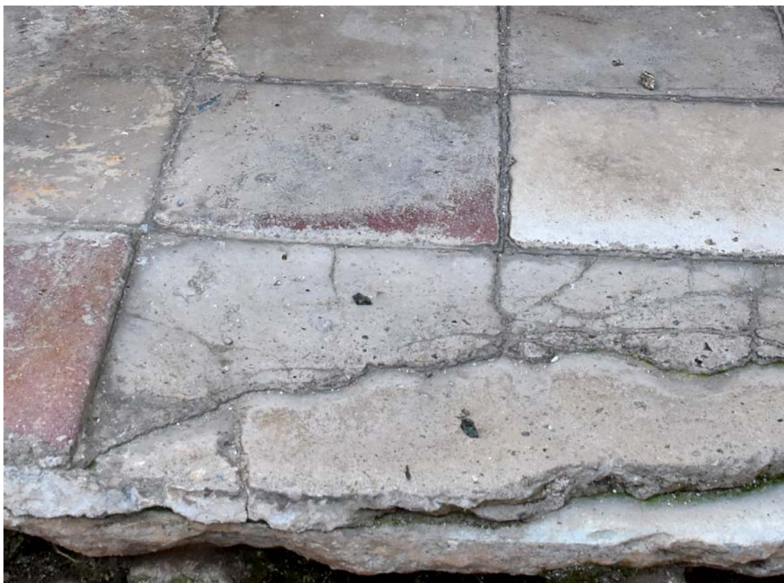
Φωτ. 473. Λεπτομέρεια όπου διακρίνεται η απώλεια πλακιδίων, οι επικαθίσεις, ο αποχρωματισμός και οι έντονες μηχανικές φθορές.
