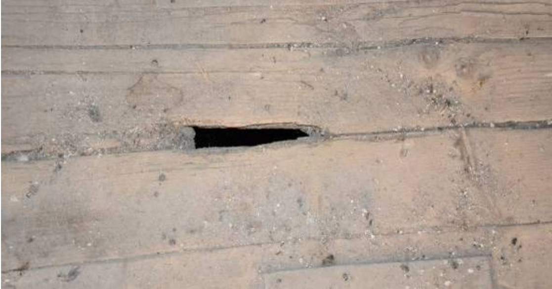
Φωτ. 207 Απώλεια ξύλινων στοιχείων, ρωγματώσεις, εκδορές και επικαθίσεις ρύπων στο δάπεδο του χώρου ΗΜ2.
