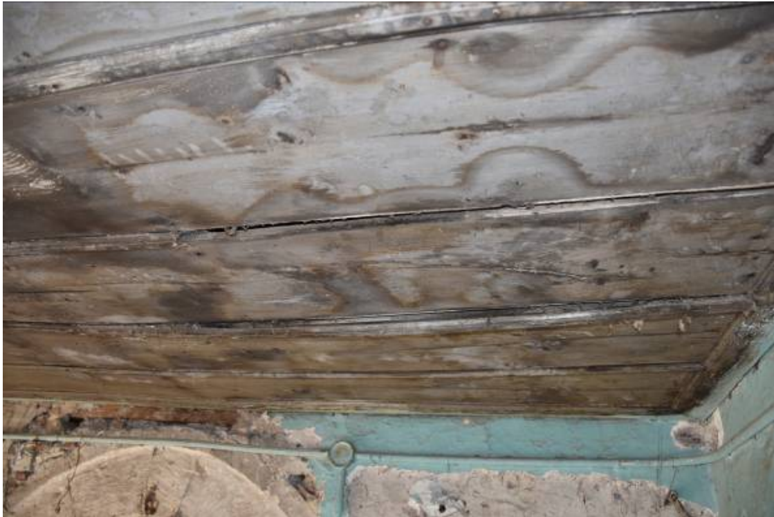
Φωτ. 193 Στρεβλώσεις, αποκολλήσεις και προσβολή από σηπτικούς και χρωστικούς μύκητες στην οροφή του χώρου ΗΜ3.
