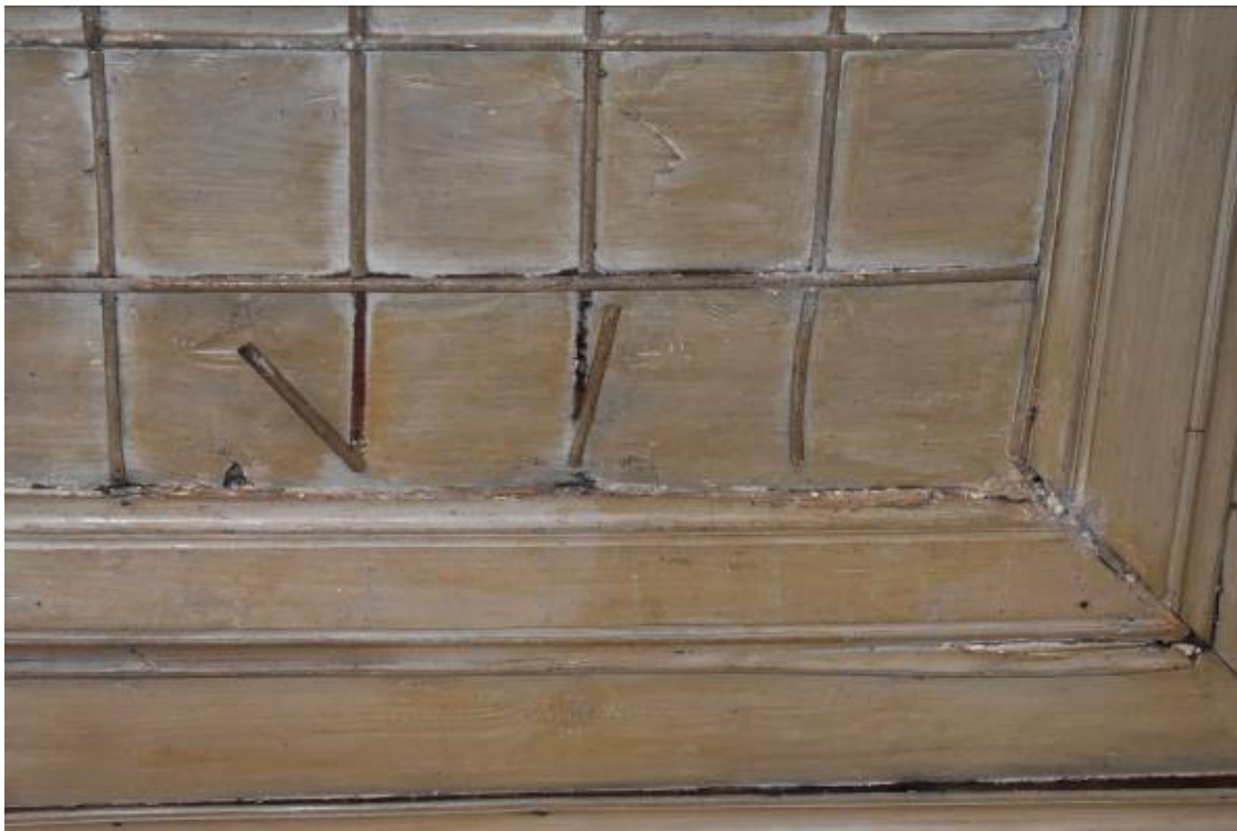
Φωτ. 189 Αποκολλημένα τμήματα στην οροφή του σοφά (Α3).
