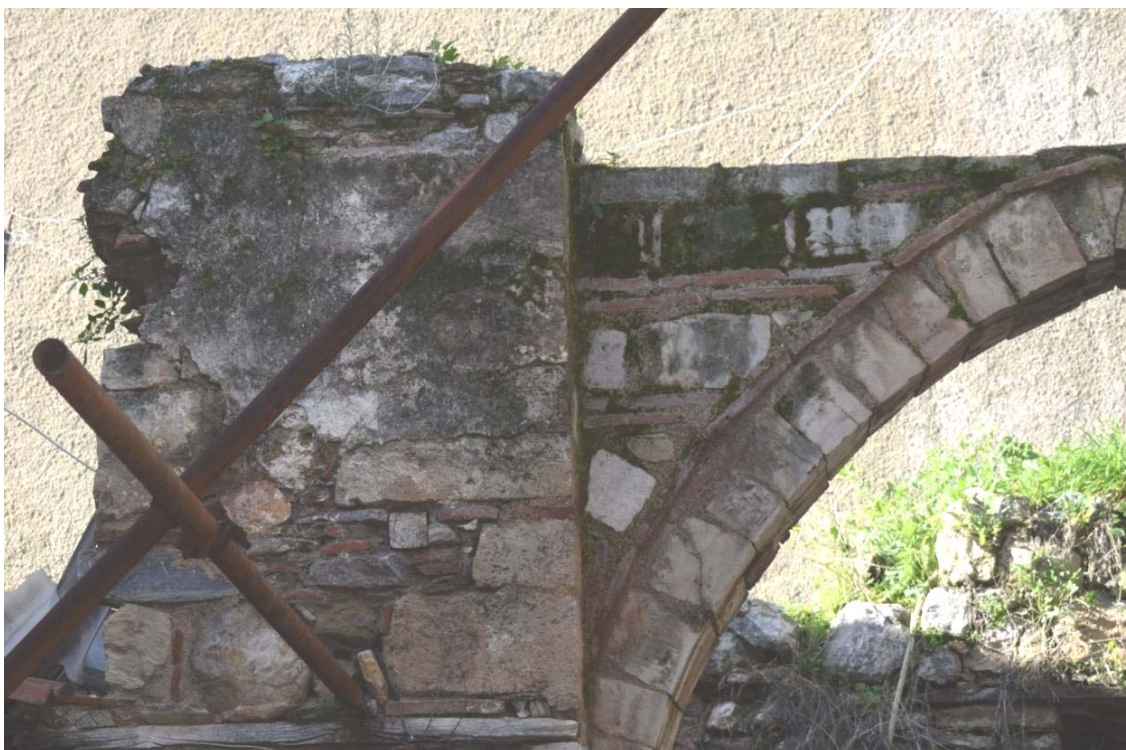
Φωτ. 404. Η συνεχής ύπαρξη υγρασίας στο μνημείο σε συνδυασμό με τη λιγοστή ηλιοφάνεια, έχει οδηγήσει στην εμφάνιση βιολογικών επικαθίσεων με την μορφή επίστρωσης στους εξωτερικούς λίθους. Βιολογικό επίστρωμα στην εξωτερική επίστεψη της αυλόθυρας. Διακρίνονται και περιορισμένης έκτασης μαύρες κρούστες.
