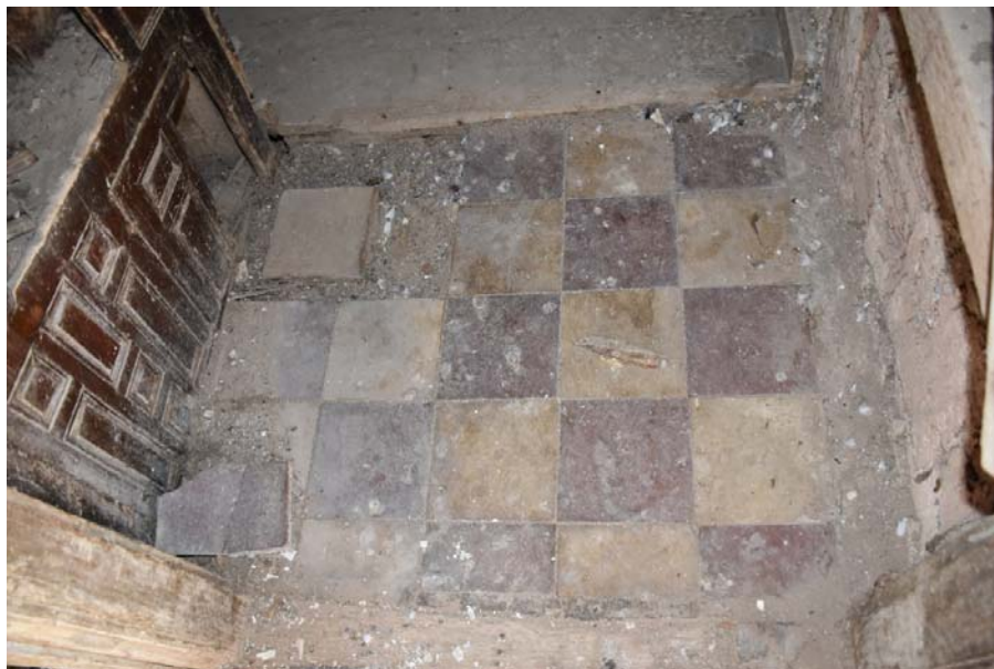
Φωτ. 389. Ο χώρος υποδοχής του ανατολικού οντά με το δάπεδο από τσιμεντοπλακίδια λευκού και κεραμιδί-κόκκινου χρώματος σε διάταξη ζατρικίου.
