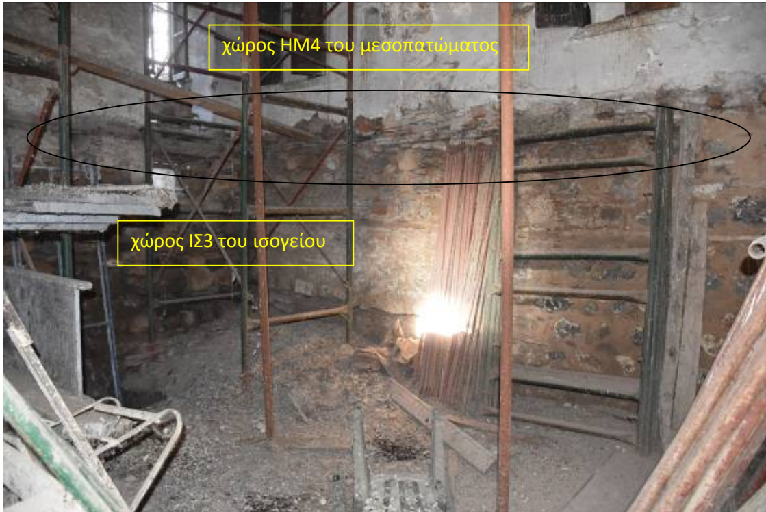
Φωτ. 13 Ο χώρος ΙΣ3 του ισογείου στον οποίον έχει καταρρεύσει η οροφή.
