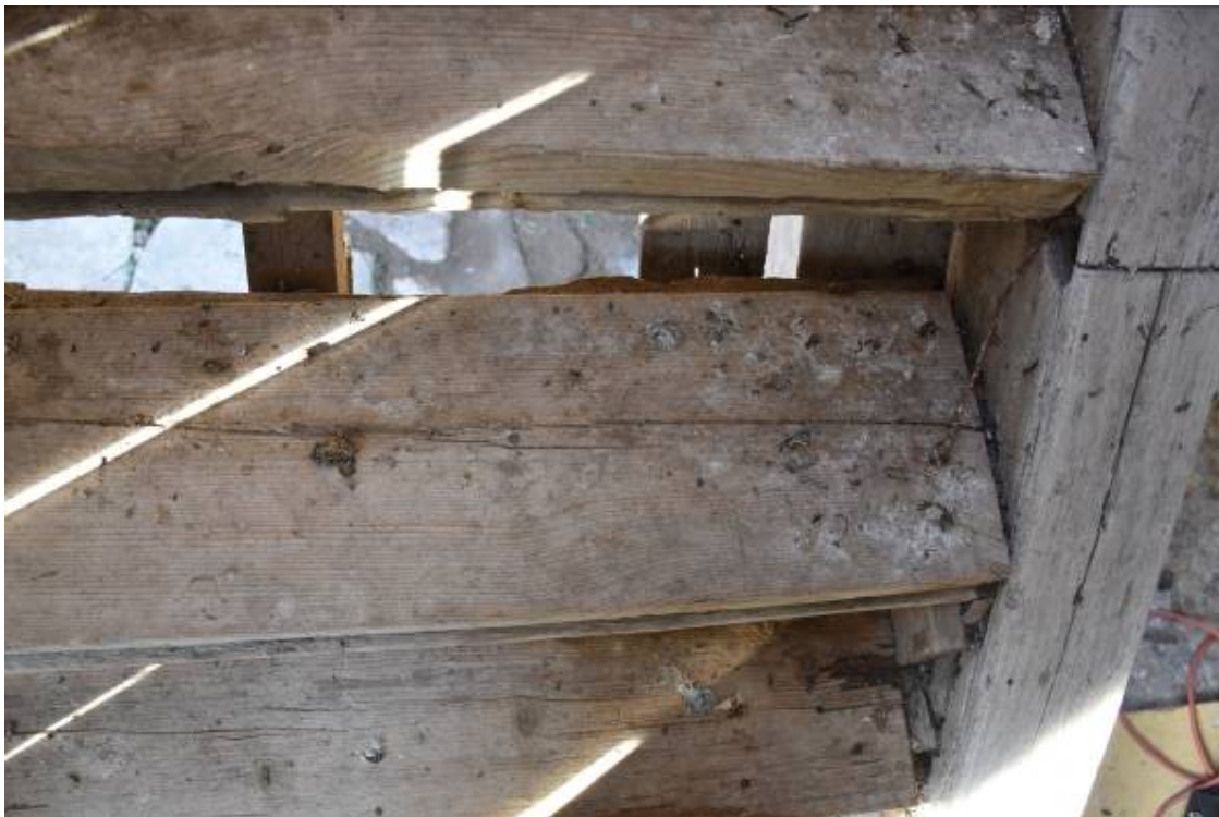
Φωτ. 282 Ρωγματώσεις του ξύλου και περιττώματα πτηνών.
