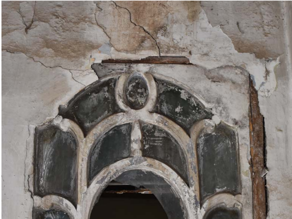
Φωτ. 317 Επιχρωματισμοί και επίχρση σε φεγγίτη της όψης του ορτά-σοφά (Α5).
