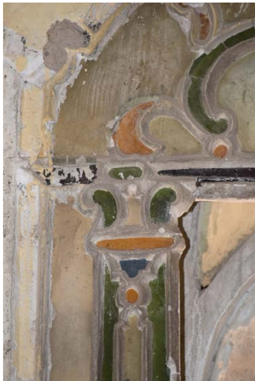
Φωτ. 315 Απώλειες του χρωματικού στρώματος στους εσωτερικούς φεγγίτες του ορτά-σοφά (A5).
