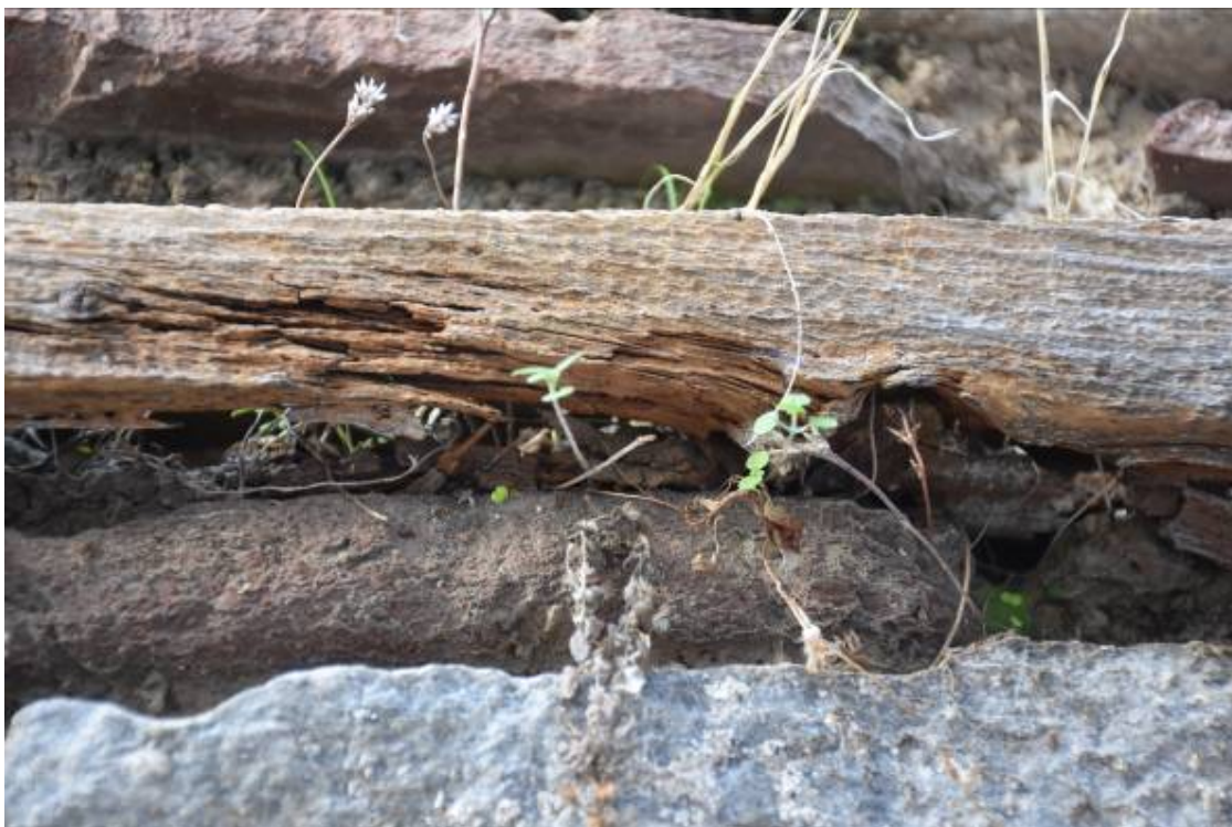
Φωτ. 292 Προσβολή από σηπτικούς μύκητες και απώλεια υλικού από τη δράση των ξυλοφάγων εντόμων στη ξυλοδεσιά της τοιχοποιίας.
