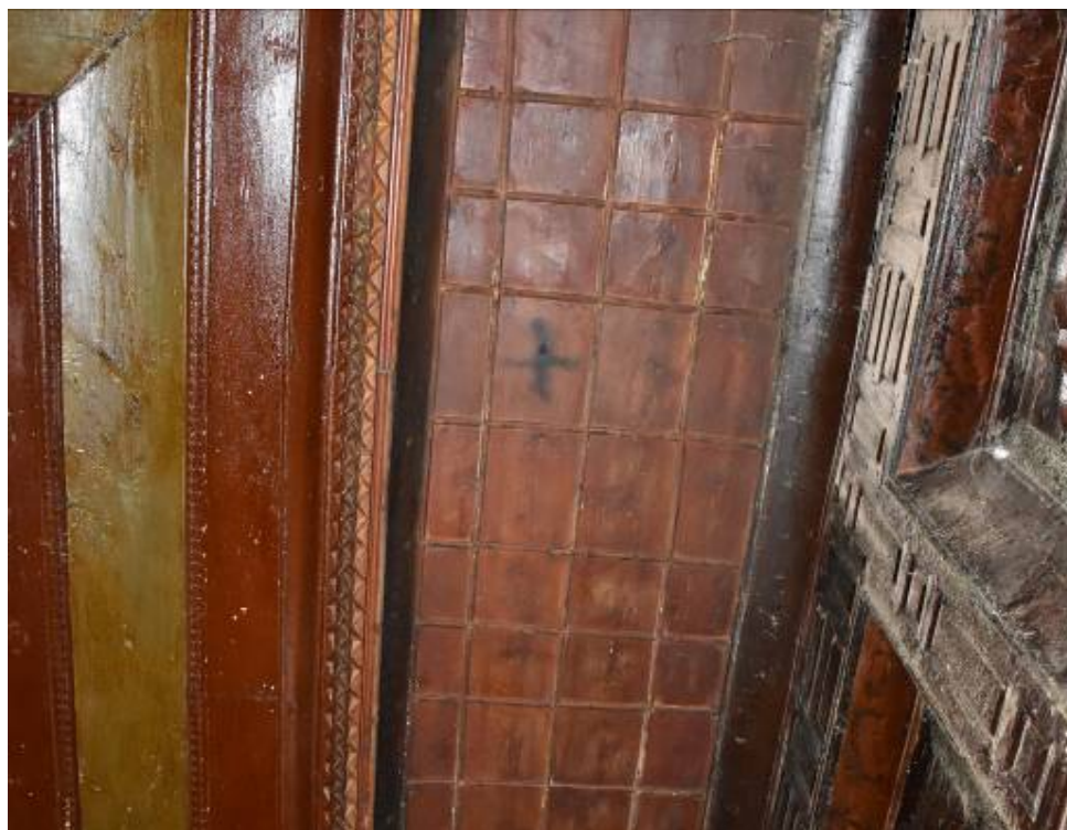
Φωτ. 204 Φθορά από θρησκευτικό έθιμο (δημιουργία σταυρού) στην οροφή του ανατολικού οντά (Α4).
