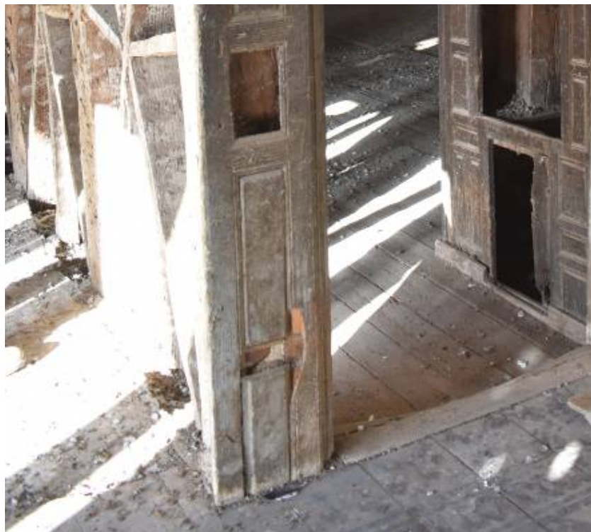
Φωτ. 257 Απώλεια ξύλινων στοιχείων από την όψη του δυτικού οντά.
