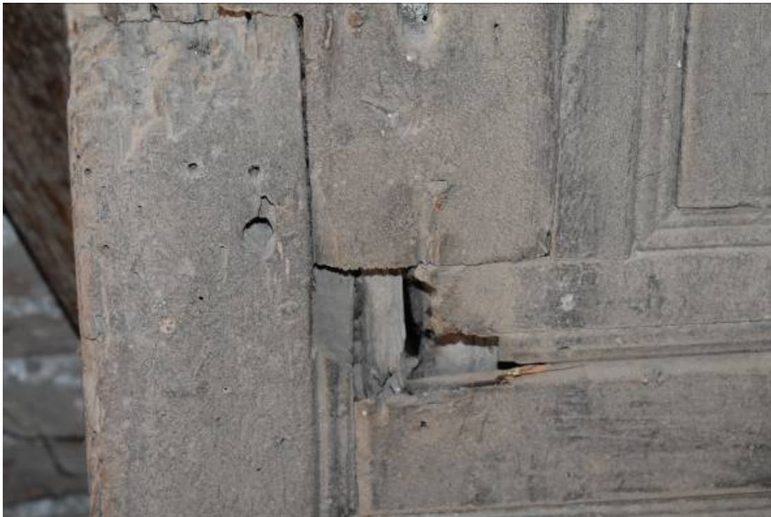
Φωτ. 222 Απώλεια ξύλινου τμήματος στη θύρα του δυτικού οντά (A6).
