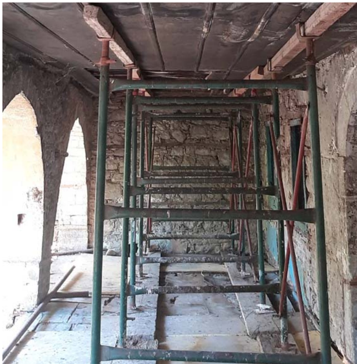
Φωτ. 333 Στο δυτικό τοίχο του χώρου ΗΜ1 υπάρχει πλήρης απώλεια των κονιαμάτων.
