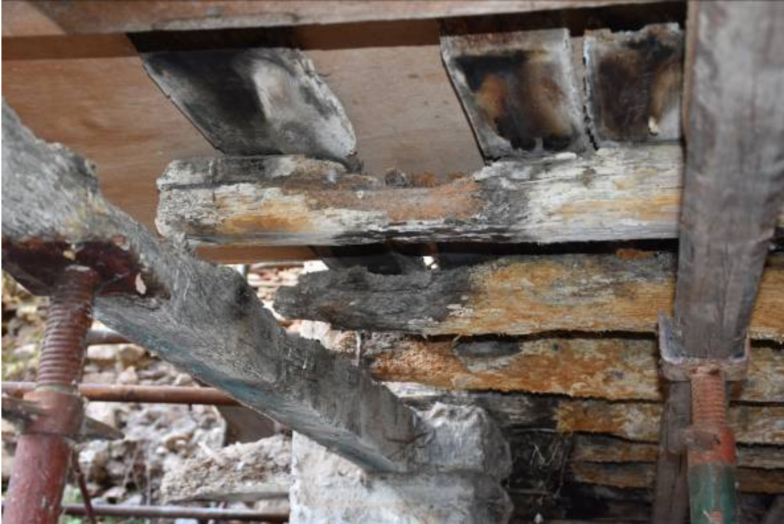
Φωτ. 307 Ρωγματώσεις, προσβολή από σηπτικούς μύκητες, απώλεια υλικού από τη δράση των ξυλοφάγων εντόμων και οξειδωμένοι μεταλλικοί σύνδεσμοι στα ξύλα των πατωμάτων.
