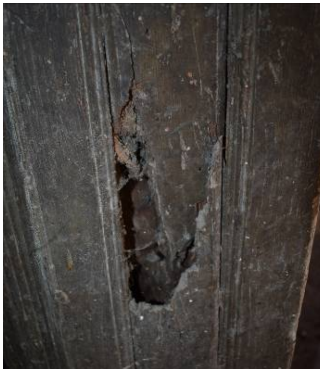
Φωτ. 258 Απώλεια ξύλινων τμημάτων από τη δράση των ξυλοφάγων εντόμων, ρωγματώσεις και προσβολή από σηπτικούς μύκητες στην όψη του ανατολικού οντά (A4).
