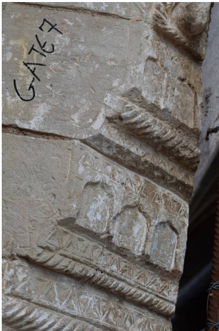
Φωτ. 452. Ανθρώπινος βανδαλισμός με τη μορφή γκράφιτι στην εξωτερική πλευρά του κτίσματος και συγκεκριμένα στην επεξεργασμένη γωνία της λιθοδομής στην επαφή με το δρόμο
