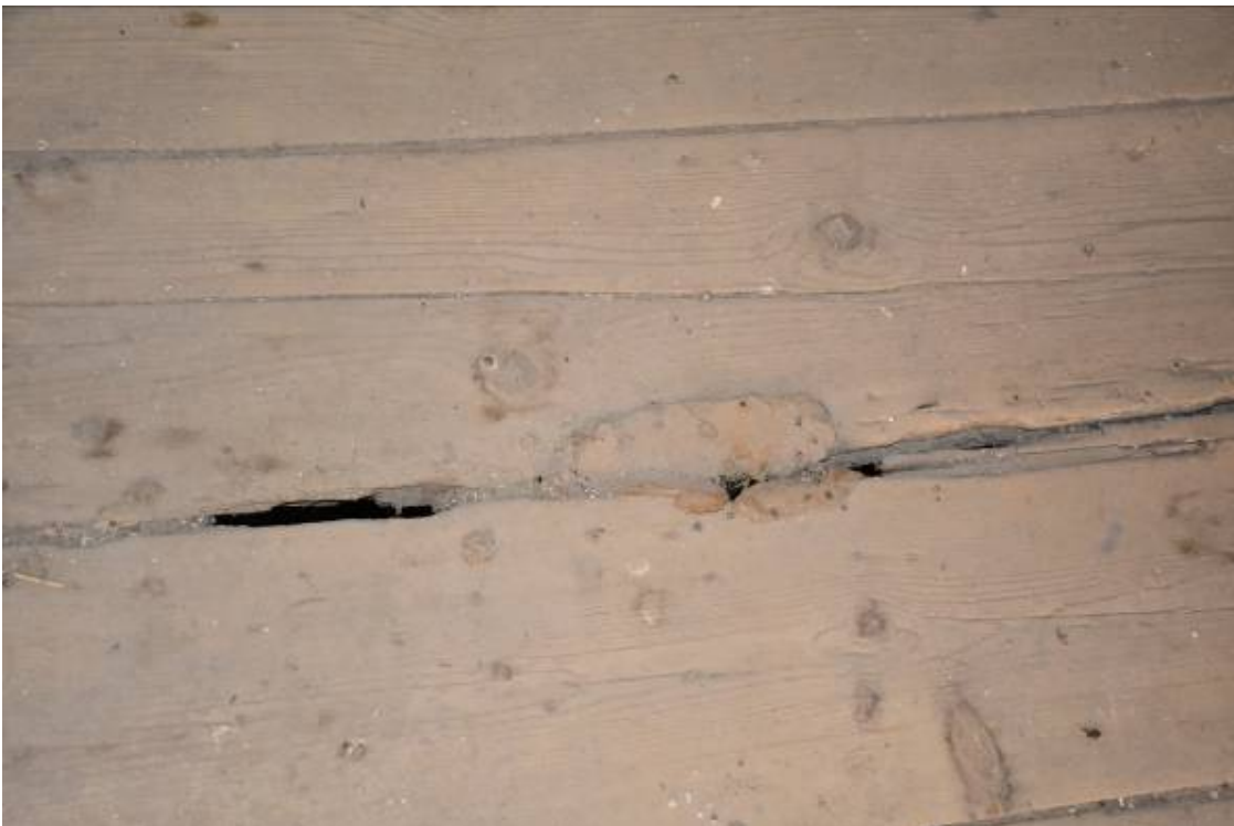
Φωτ. 208 Απώλεια ξύλινων στοιχείων, ρωγματώσεις, εκδορές και επικαθίσεις ρύπων στο δάπεδο του χώρου ΗΜ2.
