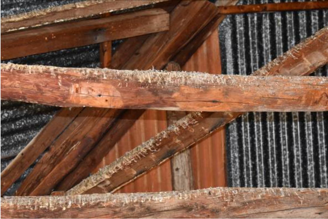
Φωτ. 289 Ρωγματώσεις, προσβολή από σηπτικούς μύκητες, οξειδωμένοι μεταλλικοί σύνδεσμοι και συσσώρευση περιττωμάτων πτηνών στα ξύλα της στέγης.
