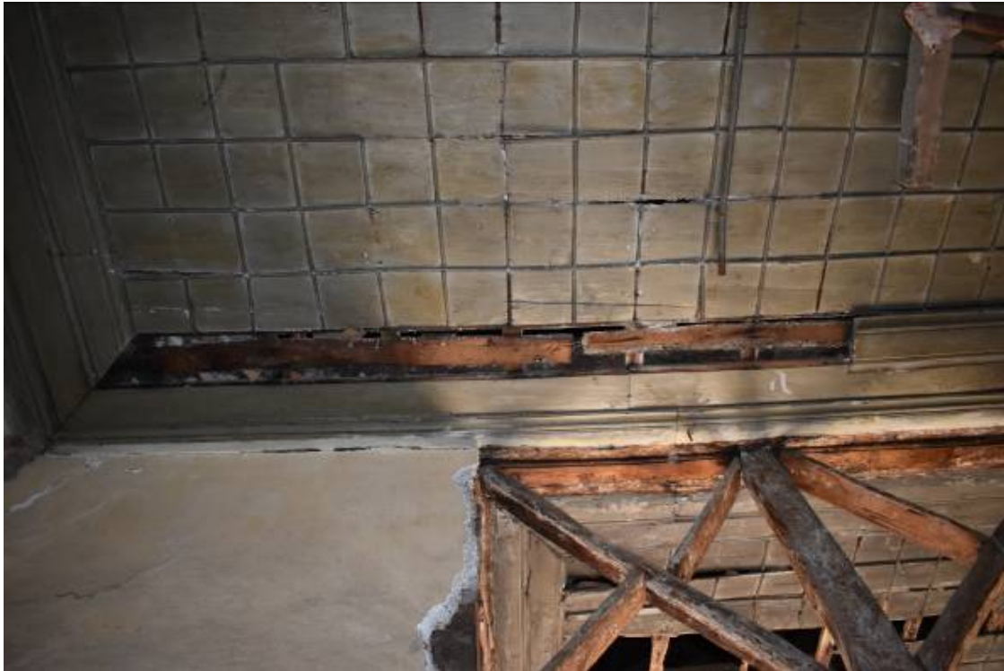
Φωτ. 181 Απώλεια τμημάτων και αποκολλημένα στοιχεία στην οροφή του σοφά (Α3).
