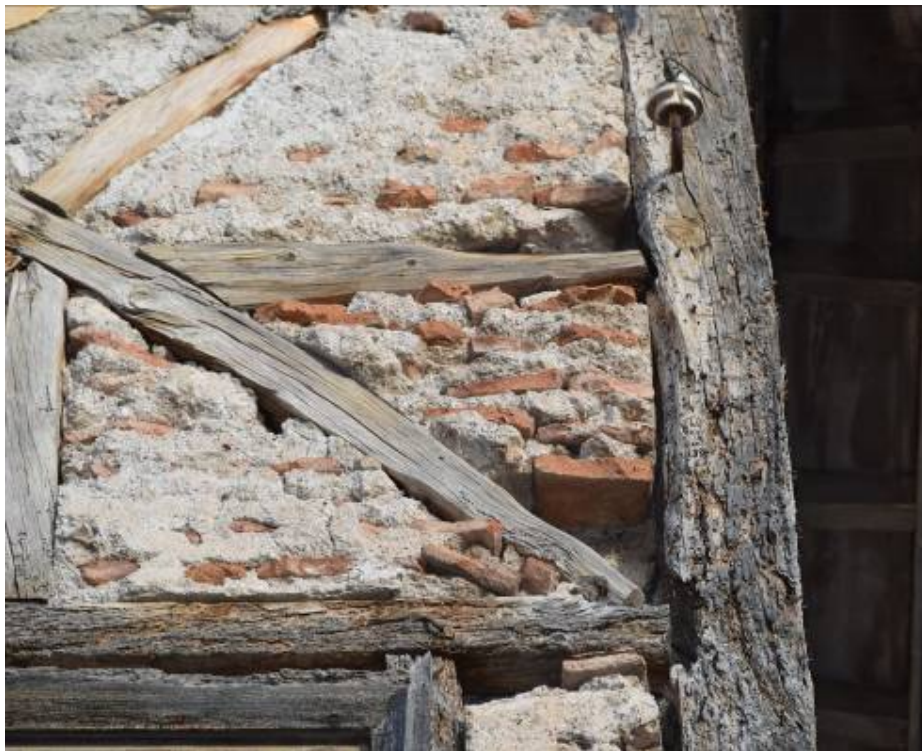
Φωτ. 295 Ρωγματώσεις, προσβολή από σηπτικούς μύκητες, απώλεια υλικού από τη δράση των ξυλοφάγων εντόμων και οξειδωμένοι μεταλλικοί σύνδεσμοι στα ξύλα της των ξυλόπηκτων τοίχων.
