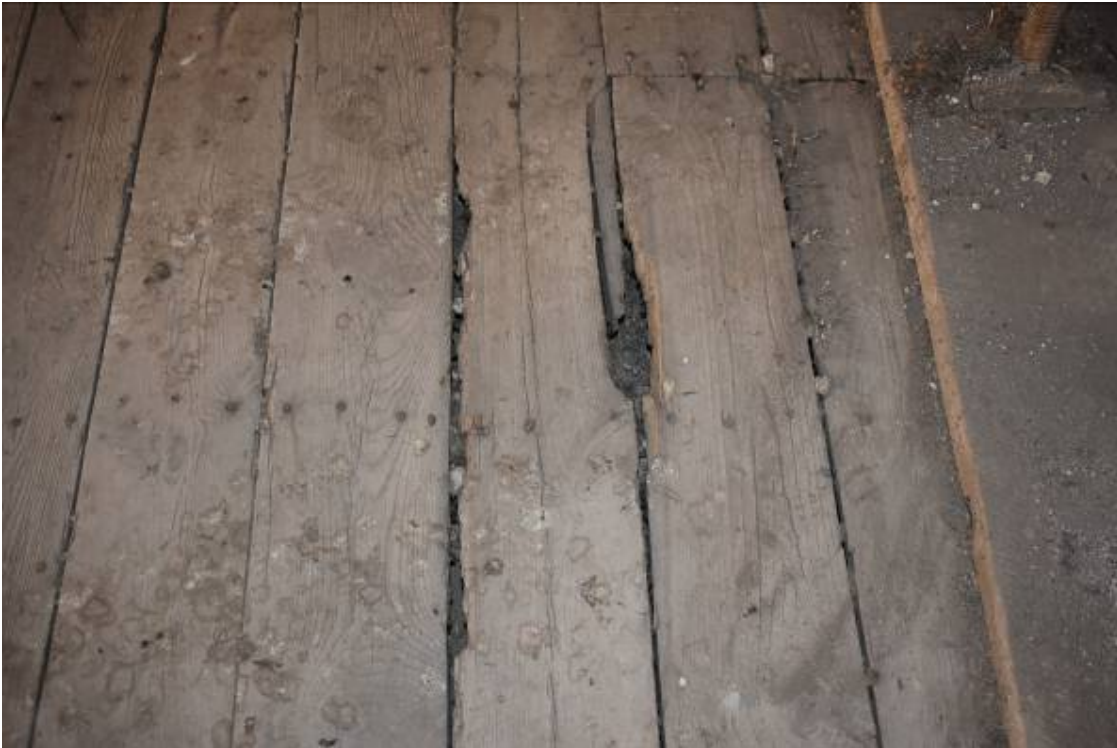
Φωτ. 210 Απώλεια ξύλινων στοιχείων από τη δράση ξυλοφάγων εντόμων, ρωγματώσεις και οξειδωμένοι μεταλλικοί σύνδεσμοι στο δάπεδο του σοφά (Α3).
