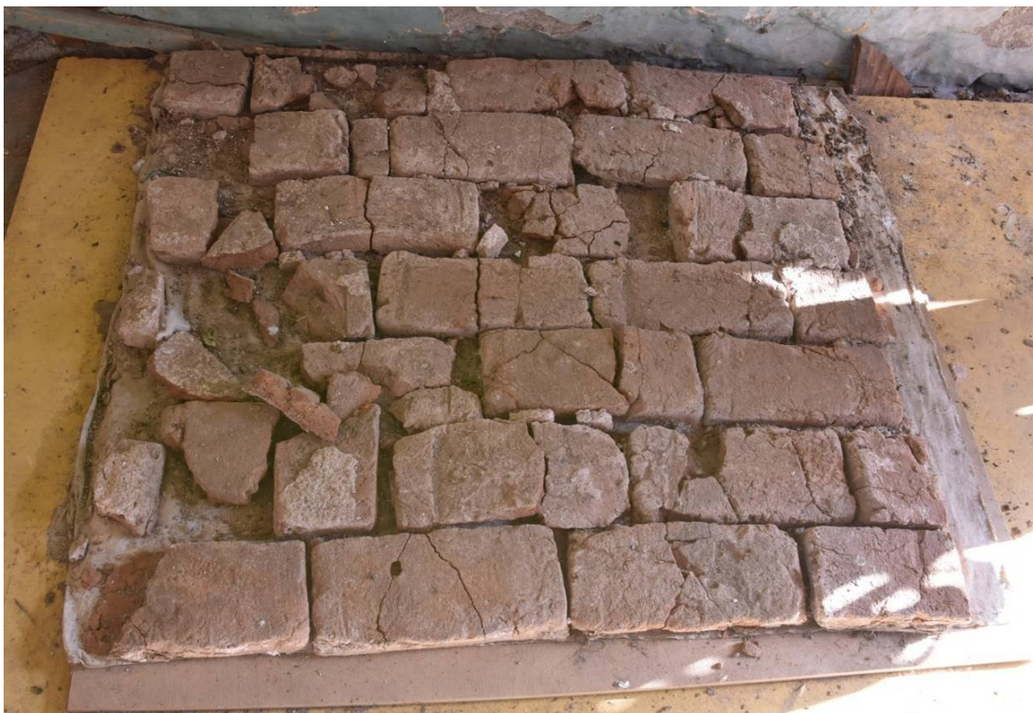
Φωτ. 456. Οι κεραμικοί πλίνθοι είναι σε κακή κατάσταση διατήρησης με πλήθος ρωγμών, σπασιμάτων και απωλειών. Επίσης διακρίνεται στρώμα επικαθίσεων στην επιφάνεια τους.
