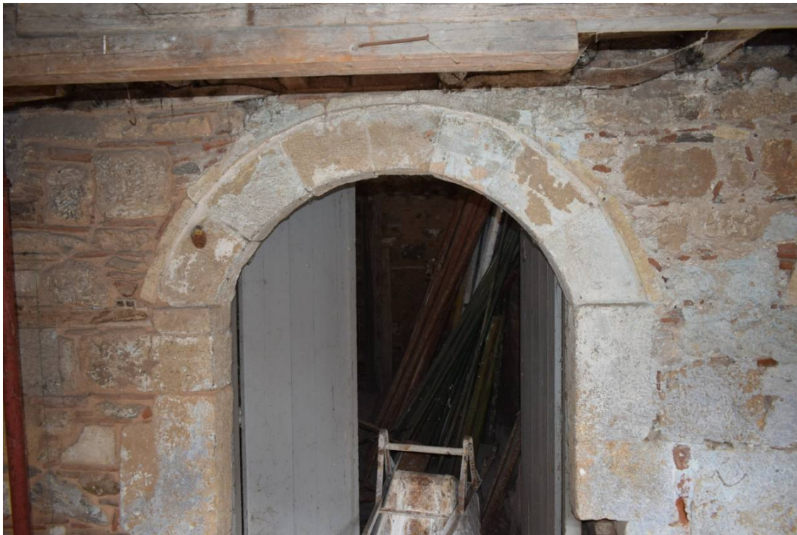
Φωτ. 426. Επιφανειακό επίστρωμα κονιάματος (βαφή) στο τοξωτό ανώφλι των θυρών του ισογείου, που έχει μερικώς φθαρεί και δημιουργεί αρνητικό αισθητικό αποτέλεσμα.
