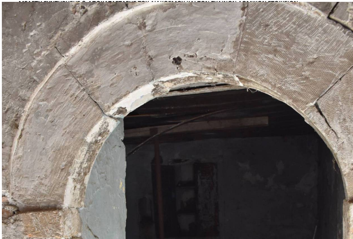
Φωτ. 437. Φθορά των λίθων στο ανώφλι της πόρτας. Διακρίνεται μεγάλη ρωγμή δεξιά, πιθανόν λόγω μηχανικής καταπόνησης.
