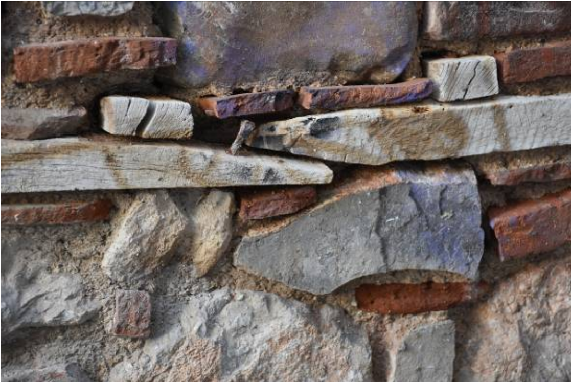
Φωτ. 293 Ρωγματώσεις και οξειδωμένοι μεταλλικοί σύνδεσμοι στη ξυλοδεσιά της τοιχοποιίας.
