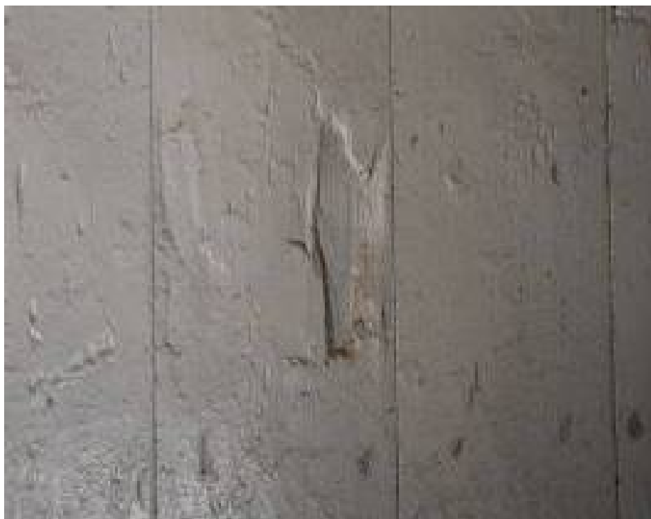
Φωτ. 221 Επιφανειακή απώλεια ξύλινου τμήματος στη επιχρωματισμένη θύρα του ΗΜ3.
