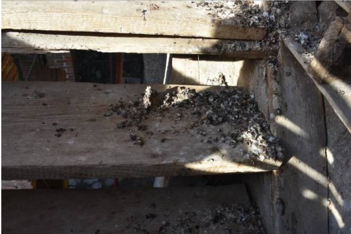
Φωτ. 285 Ρωγματώσεις και συσσώρευση περιττώματα πτηνών.
