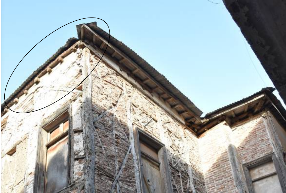
Φωτ. 308 Απώλεια τμήματος του γείσου.
