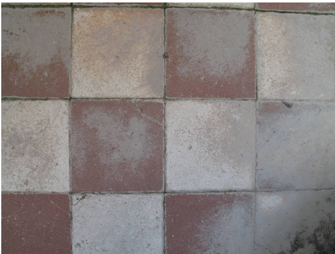
Φωτ. 471. Λεπτομέρεια της κατάστασης διατήρησης των πλακιδίων της εισόδου.
