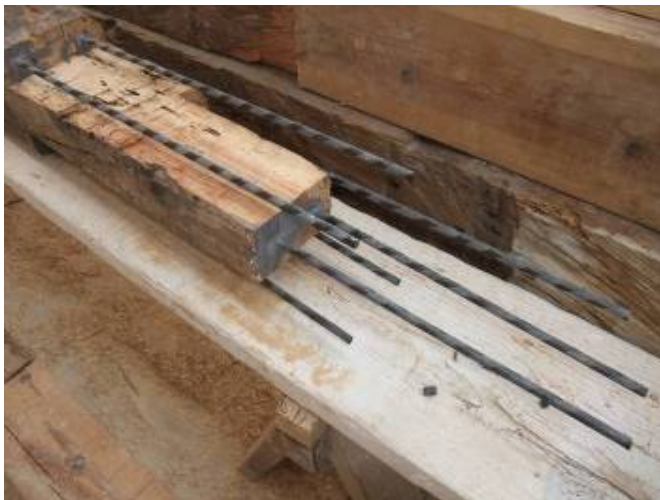
Φωτ. 342 Συμπλήρωση της δοκού, με ξύλο ίδιας βοτανικής προέλευσης και χρήση ανθρακοράβδων για τη σύνδεση αρχικού και νέου ξύλου. Στις οπές των ράβδων και στη διεπιφάνεια των ξύλων χρησιμοποιείται ρητίνη.
