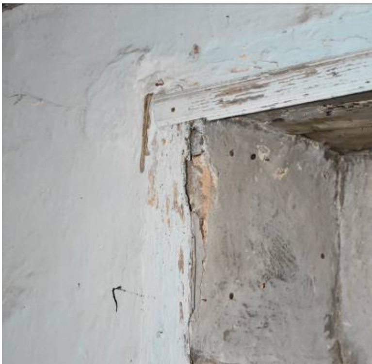
Φωτ. 272 Απώλεια υλικού από τη δράση των ξυλοφάγων εντόμων και προσβολή από σηπτικούς μύκητες σε ερμάριο του χώρου ΗΜ3.
