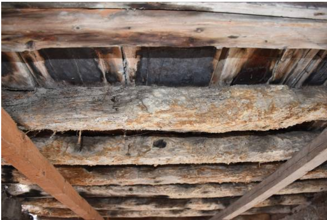
Φωτ. 305 Ρωγματώσεις, προσβολή από σηπτικούς μύκητες, απώλεια υλικού από τη δράση των ξυλοφάγων εντόμων και οξειδωμένοι μεταλλικοί σύνδεσμοι στα ξύλα των πατωμάτων.
