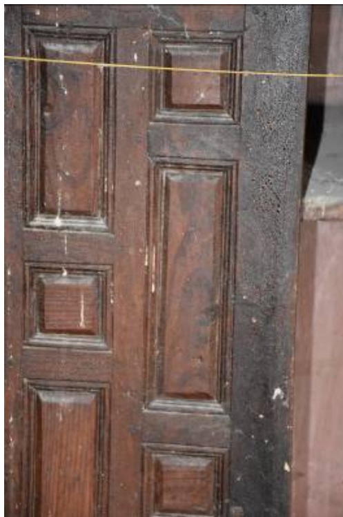
Φωτ. 277 Οξειδωμένο βερνικόχρωμα σε ερμάριο του ορτά-σοφά (Α5).
