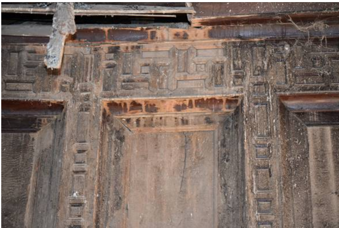
Φωτ. 254 Ρωγμάτωση και απώλεια χρωματικού στρώματος έως την επιφάνεια του ξύλου.
