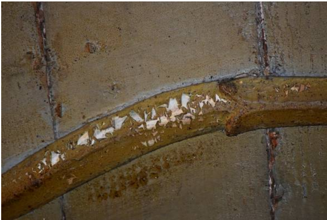
Φωτ. 201 Απώλειες χρωματικού διακόσμου και αποκολλημένο χρωματικό στρώμα στην οροφή του ανατολικού οντά (Α4). Επίσης διακρίνεται υποκείμενος χρωματικός διάκοσμος κάτω από το αποκολλημένο υπερκείμενο χρωματικό στρώμα.
