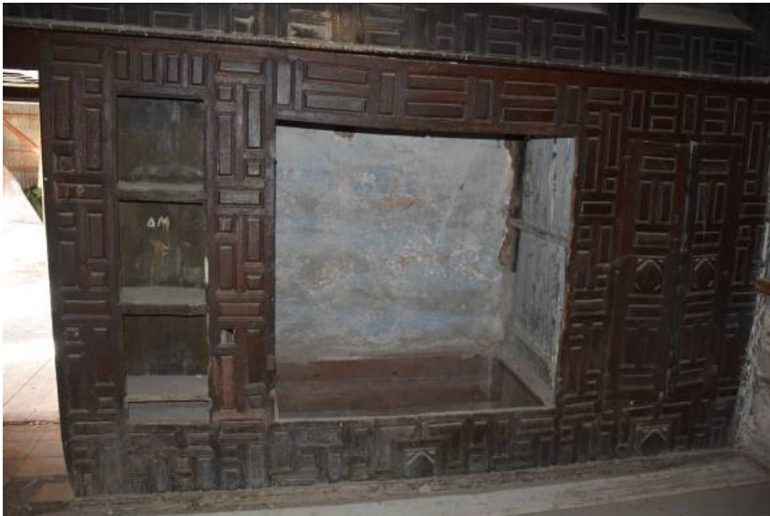
Φωτ. 241 Απώλεια ξύλινων στοιχείων (νταμπάδες, φύλλα και διακοσμητικές γωνίες) στη μουσάντρα του ανατολικού οντά (Α4).
