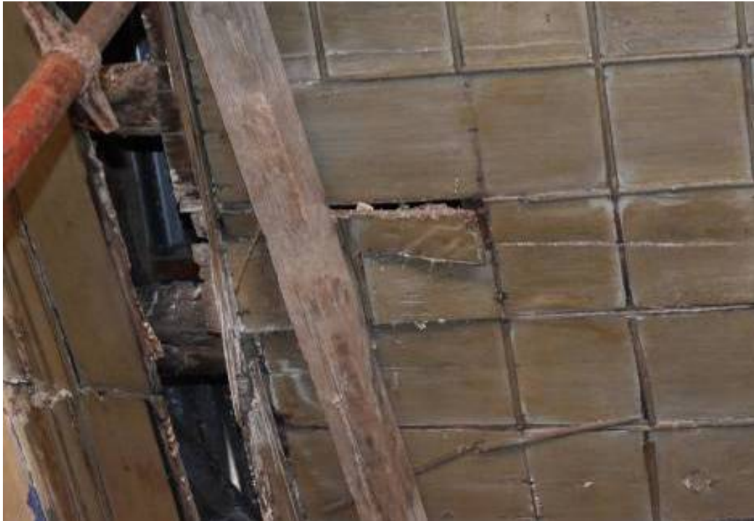
Φωτ. 183 Απώλεια τμημάτων και αποκολλημένα στοιχεία στην οροφή του σοφά (Α3).
