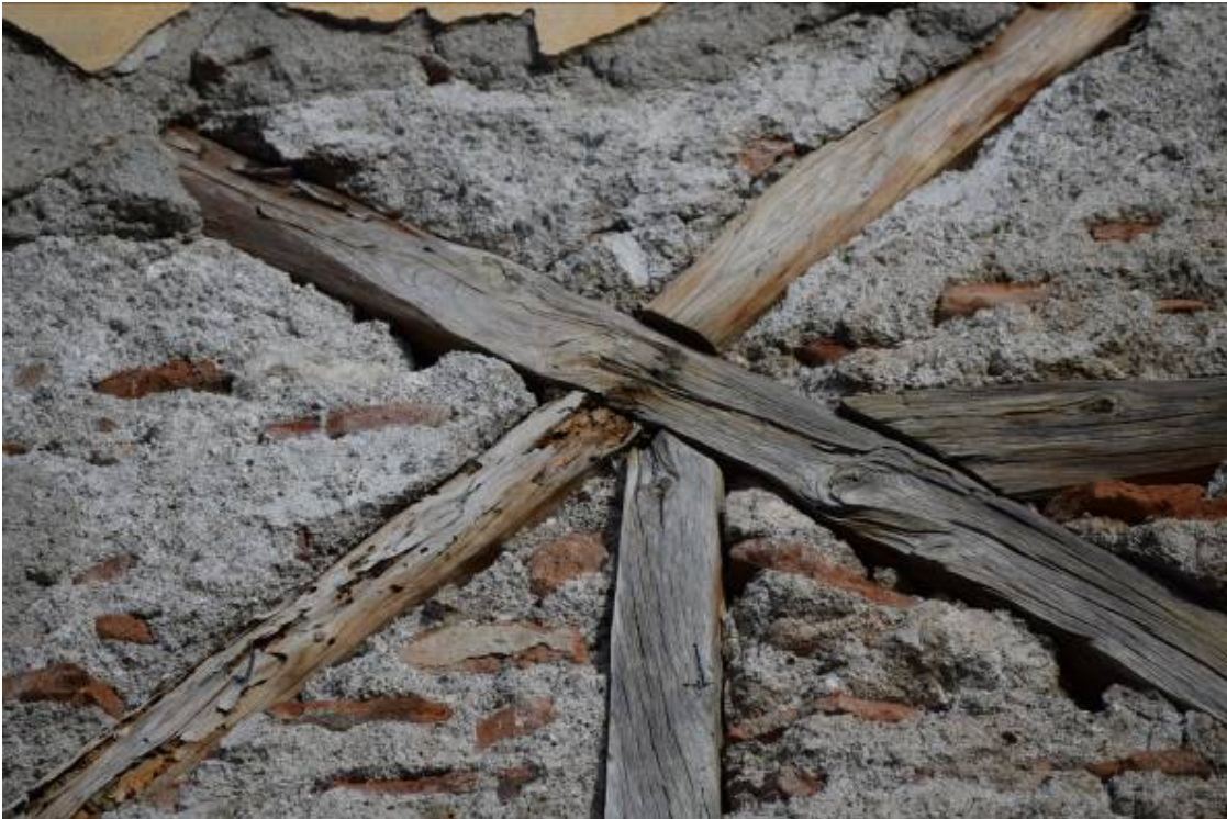
Φωτ. 294 Ρωγματώσεις, προσβολή από σηπτικούς μύκητες, απώλεια υλικού από τη δράση των ξυλοφάγων εντόμων και οξειδωμένοι μεταλλικοί σύνδεσμοι στα ξύλα της των ξυλόπηκτων τοίχων.
