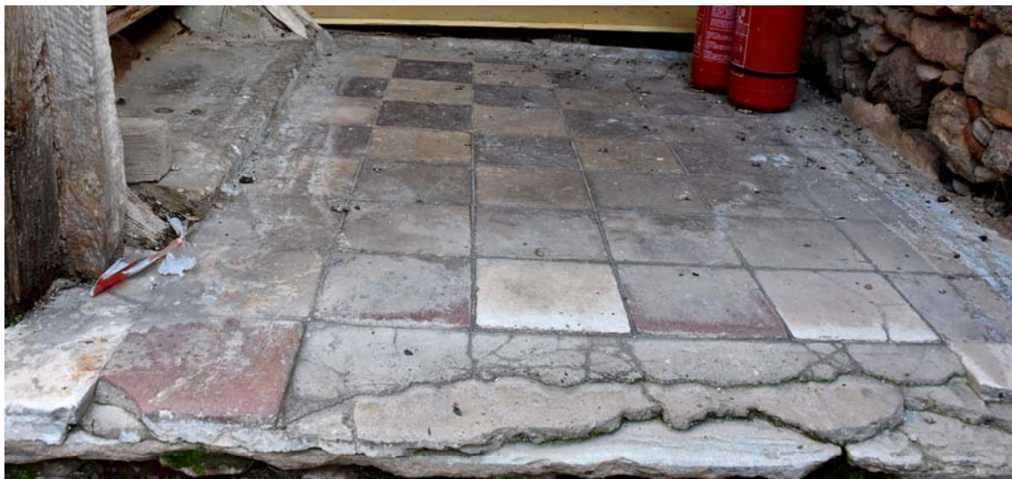
Φωτ. 472. Τιμεντοπλακίδια στο πλατύσκαλο του μεσοπατώματος. Επιφάνεια καλυμμένη από επικαθίσεις, σε λεπτότερα ή παχύτερα στρώματα. Σημειακές επικαθίσεις αλάτων, διάνοιξη αρμών με απώλεια υλικού, μερικός αποχρωματισμός κεραμιδί πλακιδίων. Έντονες μηχανικές φθορές, όπως ρωγμές και ρηγματώσεις. Αποτμήσεις και απολεπίσεις, ειδικά στις ακμές τους και στους αρμούς. Απώλεια σχεδόν ολόκληρης της πρώτης σειράς πλακιδίων.
