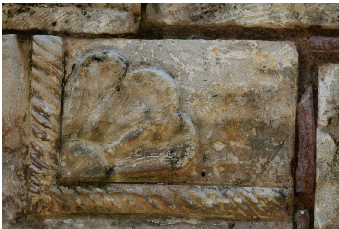
Φωτ. 413. Περιβαλλοντικές επικαθίσεις και μαύρες κρούστες σημειακά στον διακοσμημένο λίθο της αυλόθυρας δεξιά της ξύλινης πόρτας.
