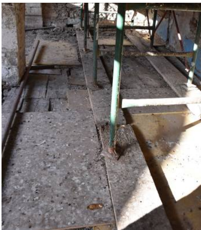
Φωτ. 67 Το δάπεδο του χώρου ΗΜ1, κάτω από τα προστατευτικά ξύλα.
