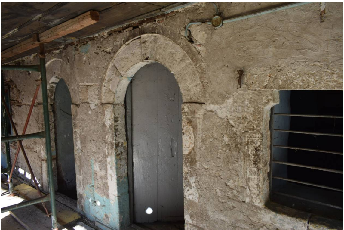
Φωτ. 429. Επιφανειακό επίστρωμα κονιάματος (βαφή γαλάζιου χρώματος) στο τοξωτό ανώφλι των θυρών του μεσοπατώματος, που έχει μερικώς φθαρεί και δημιουργεί αρνητικό αισθητικό αποτέλεσμα. Διακρίνεται επίσης και στρώμα επικαθίσεων, διάνοιξη των αρμών και μετακίνηση των λίθων από τη θέση τους.
