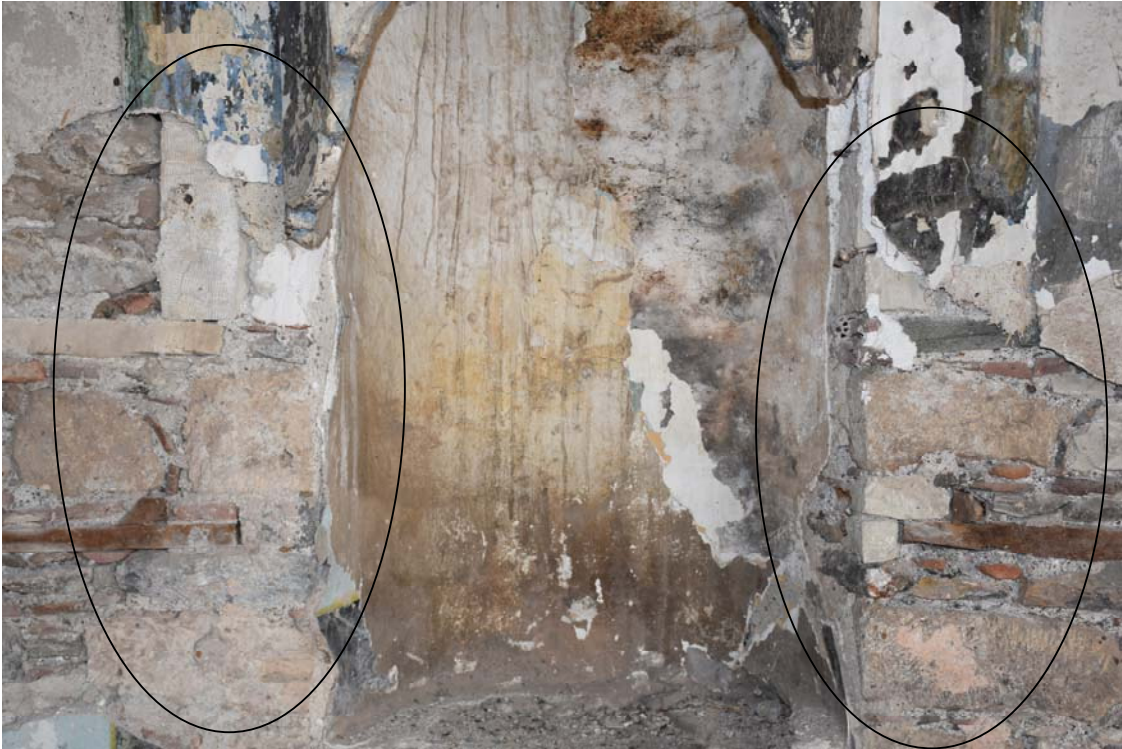
Φωτ. 318 Απώλεια του κατώτερου τμήματος της περιμετρικής γύψινης κορνίζας του τζακιού.
