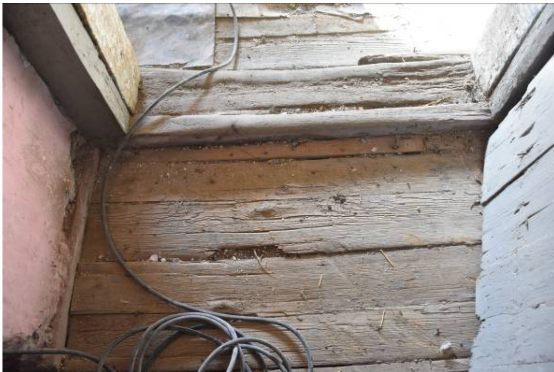
Φωτ. 211 Απώλεια ξύλινων στοιχείων, ρωγματώσεις και εκδορές στο δάπεδο του χώρου ΗΜ2.
