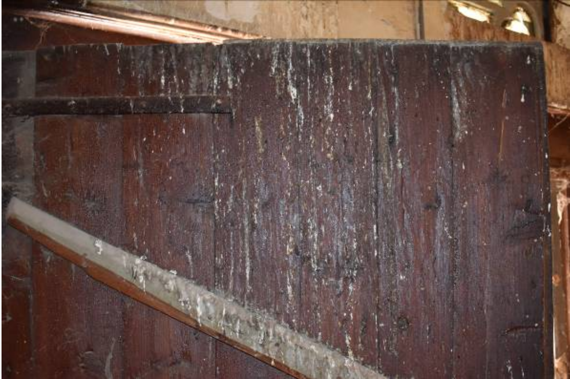
Φωτ. 239 Περιπτώματα πτηνών στη θύρα του ορτά-σοφά (A5).
