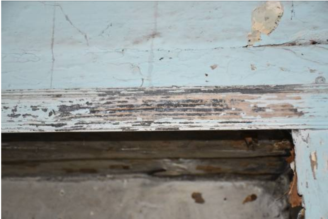
Φωτ. 280 Επιχρωματισμοί σε ερμάριο του χώρου ΗΜ3.
