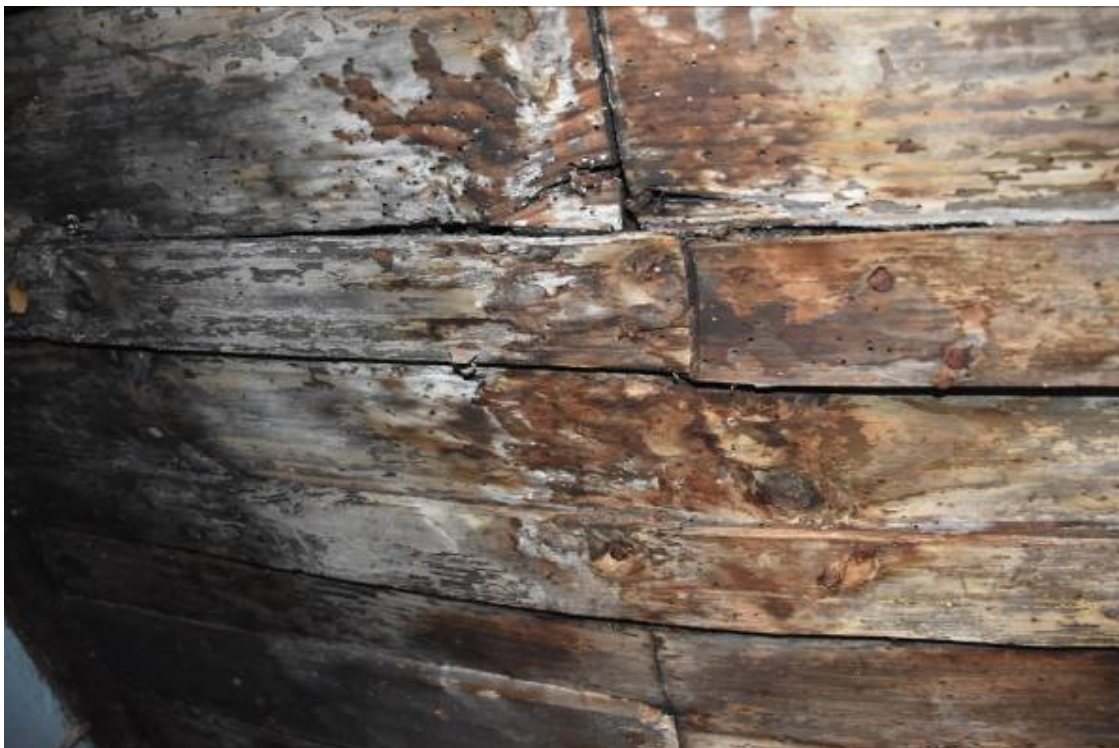
Φωτ. 192 Προσβολή από σηπτικούς μύκητες και ξυλοφάγα έντομα στην οροφή του χώρου ΗΜ3.
