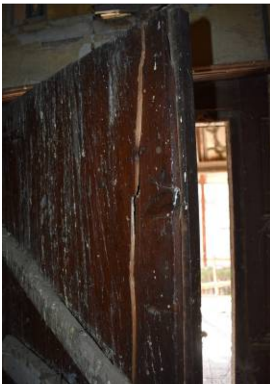
Φωτ. 224 Ρωγμάτωση στη θύρα του ορτά-σοφά (A5).
