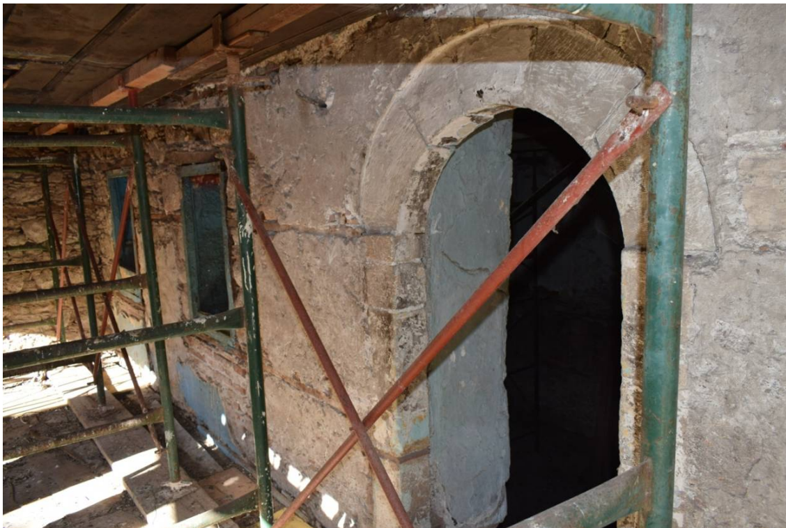
Φωτ. 430.Επιφανειακό επίστρωμα κονιάματος (βαφή γαλάζιου χρώματος) στο τοξωτό ανώφλι των θυρών του μεσοπατώματος, που έχει μερικώς φθαρεί και δημιουργεί αρνητικό αισθητικό αποτέλεσμα. Διακρίνεται επίσης παχύ στρώμα επικαθίσεων.
