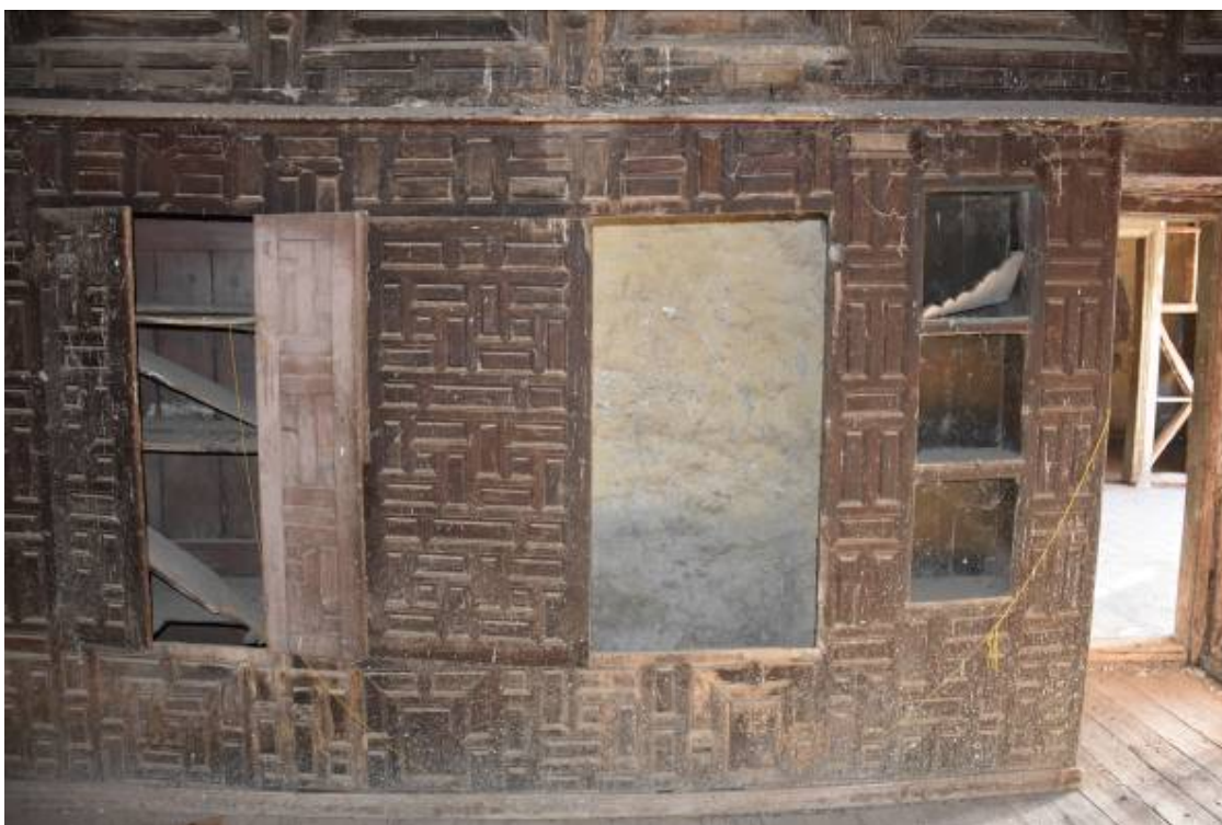
Φωτ. 242 Απώλεια ξύλινων στοιχείων (νταμπάδες, φύλλα και διακοσμητικές γωνίες) στη μουσάντρα του δυτικού οντά (Α6).
