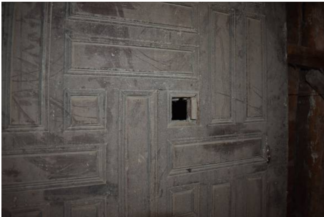
Φωτ. 218 Απώλεια ξύλινου στοιχείου στη θύρα του δυτικού οντά (Α6).
