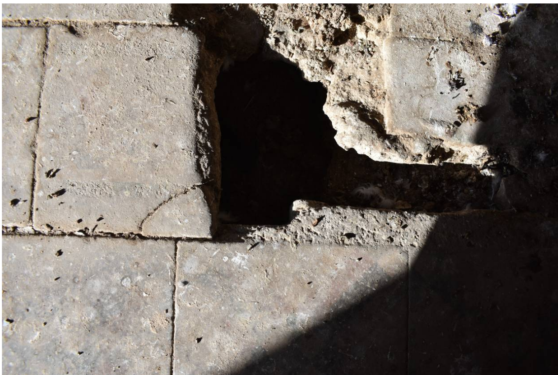
Φωτ. 479-480. Το δάπεδο στο χαγιάτι, όπου η επιφάνεια σε σημεία είναι πλήρως καλυμμένη από επικαθίσεις. Παρατηρείται επίσης διάνοιξη των αρμών με απώλεια υλικού. Έντονες μηχανικές φθορές σημειακά, όπως ρωγμές και απώλειες τμημάτων πλακιδίων. Αποτμήσεις και απολεπίσεις, ειδικά στις ακμές τους και στους αρμούς.
