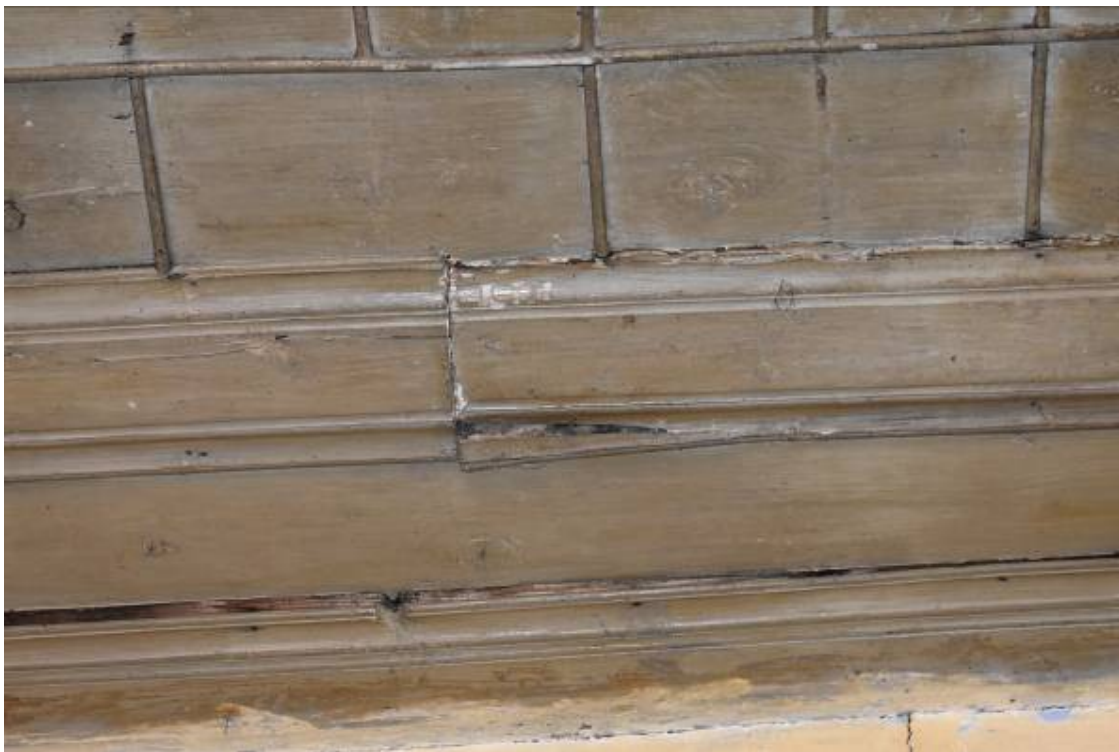
Φωτ. 190 Αποκολλημένα τμήματα στην οροφή του σοφά (Α3).
