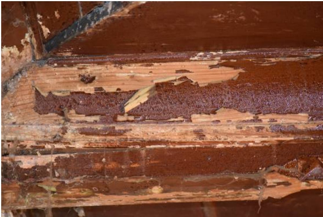
Φωτ. 199 Απώλειες χρωματικού διακόσμου, αποκολλημένο ζωγραφικό στρώμα και συρρίκνωση βερνικιού στην οροφή του ανατολικού οντά (Α4).
