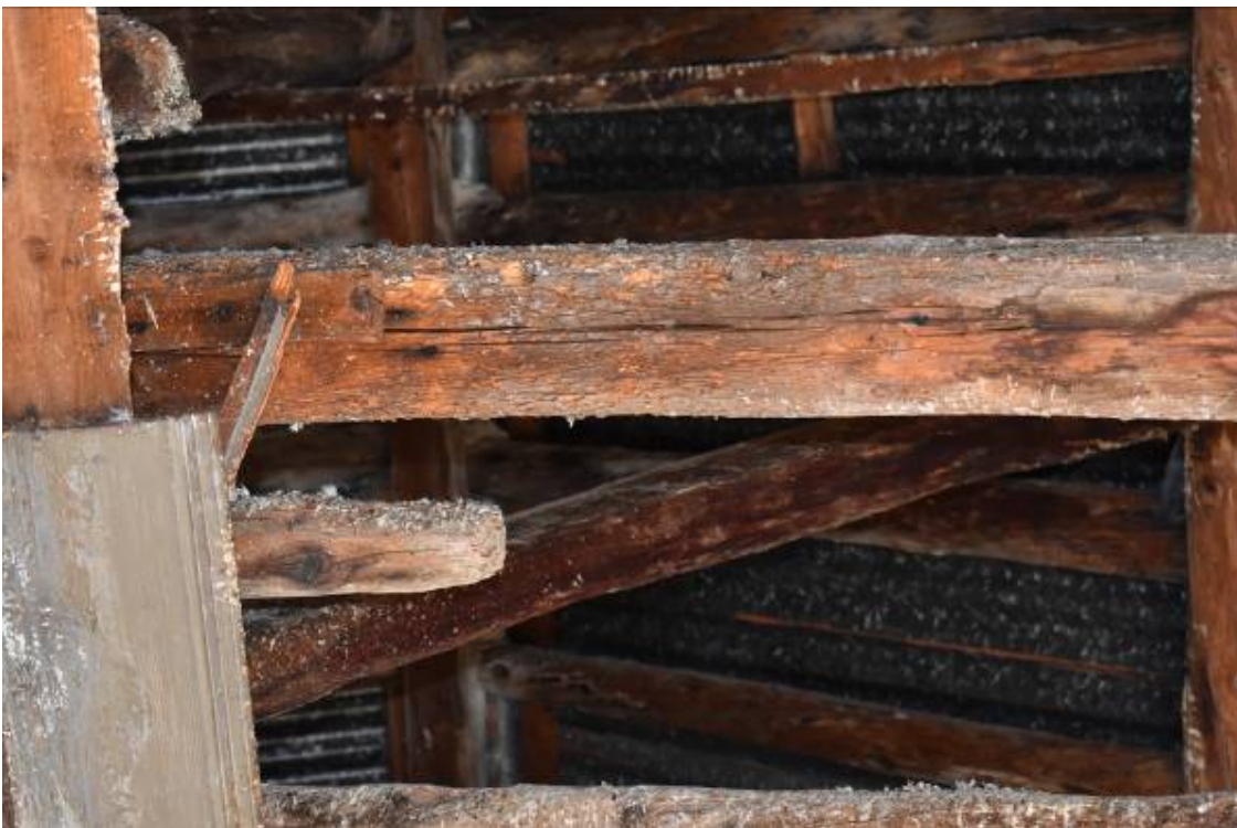
Φωτ. 290 Ρωγματώσεις, προσβολή από σηπτικούς μύκητες και ξυλοφάγα έντομα, οξειδωμένοι μεταλλικοί σύνδεσμοι και συσσώρευση περιττωμάτων πτηνών στα ξύλα της στέγης.
