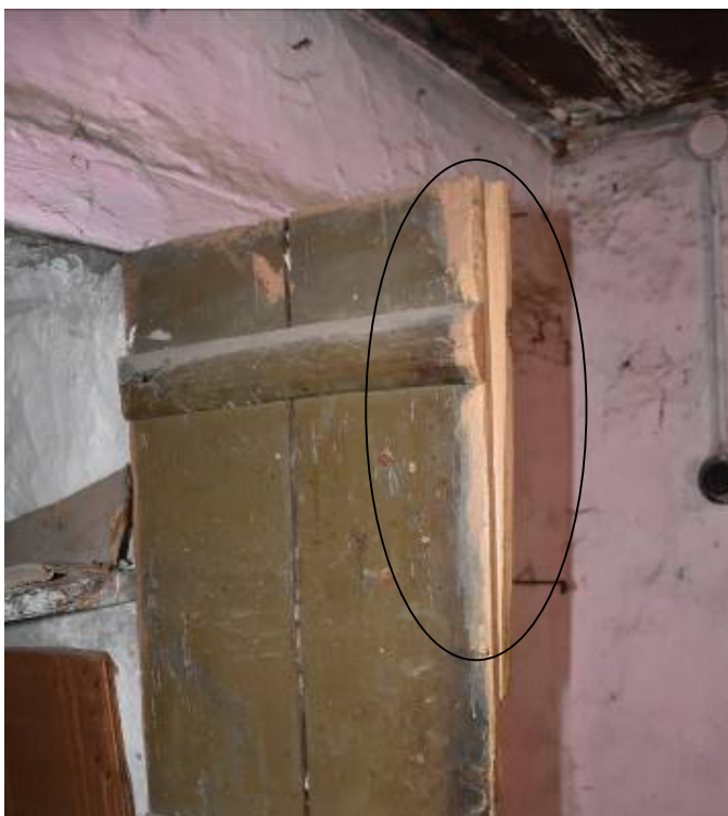
Φωτ. 279 Επιχρωματισμοί σε ερμάριο του χώρου ΗΜ2.
