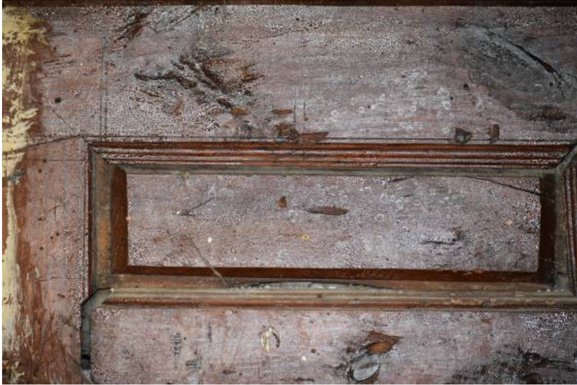
Φωτ. 274 Εκδορές σε ερμάριο του ορτά-σοφά (A5).
