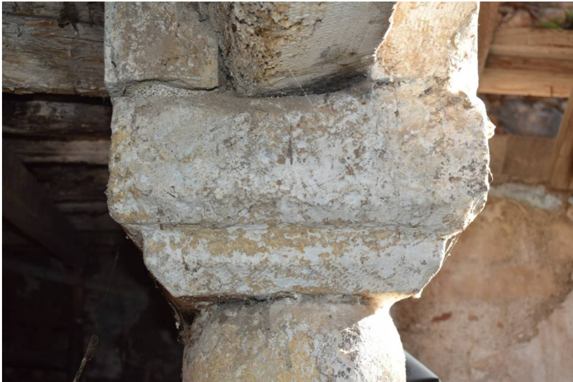
Φωτ. 418. Στρώμα περιβαλλοντικών επικαθίσεων, περιττώματα πτηνών και στρώμα κονιάματος και βαφής στο λίθινο κιονόκρανο της δεξιάς κολώνας του ισογείου.
