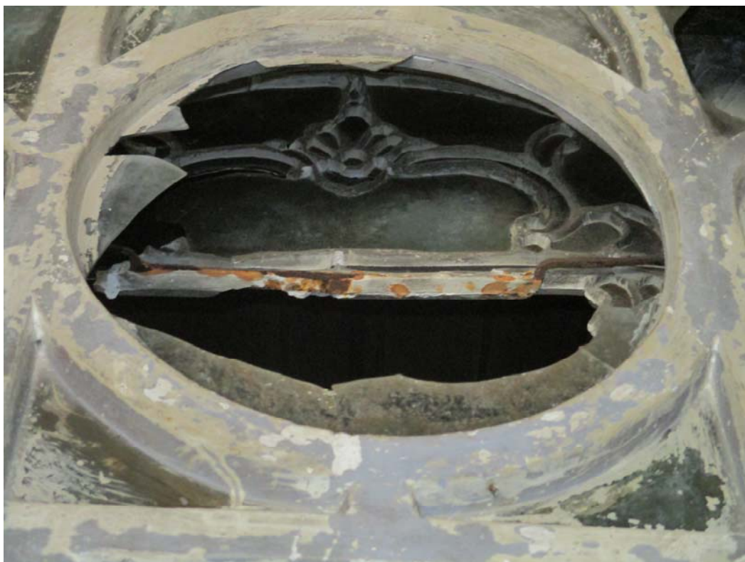
Φωτ. 467. Λεπτομέρεια της κατάστασης διατήρησης του φεγγίτη, σπασμένη υαλώδης επιφάνεια, επικαθίσεις χρώματος, οξειδωμένα μεταλλικά στοιχεία.
