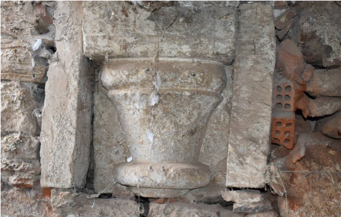
Φωτ. 416. Στρώμα περιβαλλοντικών επικαθίσεων, περιπτώματα πτηνών και υλικά από οικοδομικές δραστηριότητες στο διακοσμητικό λίθο της τοιχοποιίας της περίφραξης.
