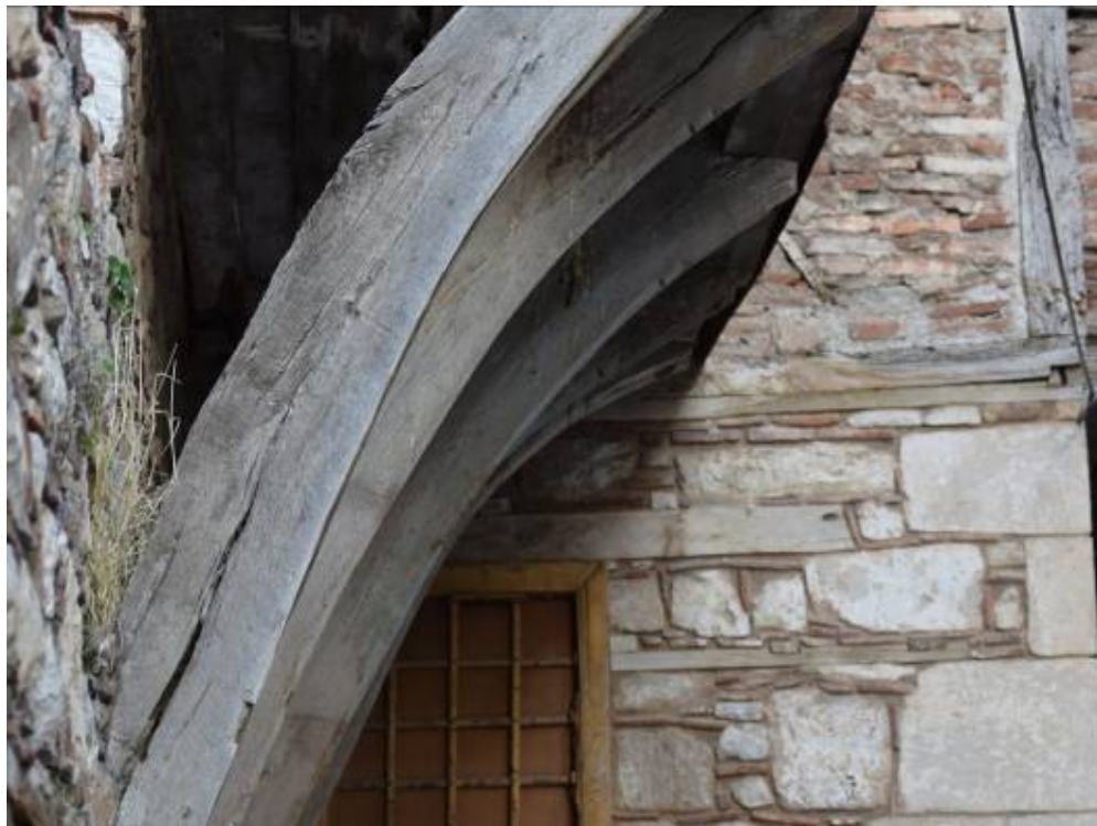
Φωτ. 300 Ρωγματώσεις στα ξύλα των σαχνισιών.
