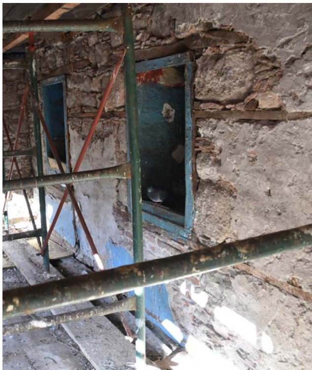
Φωτ. 335 Τοπικές απώλειες του κονιάματος και ρωγματώσεις στο βόρειο τοίχο του χώρου ΗΜ1.
