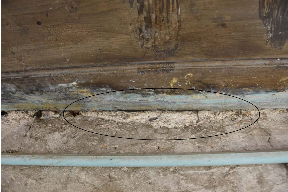
Φωτ. 337 Ίχνη του απολεσθέντος εξωτερικού κονιάματος στα ανώτερα τμήματα του βόρειου τοίχου, στα όρια με την ξύλινη οροφή.
